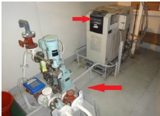
( Εικόνα 4.14 :μονάδα διοχέτευσης υγρής μορφής χημικού αριστερά - μονάδα ψύξη δεξιά )
