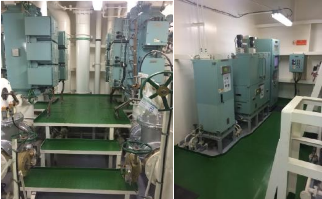
(εικόνα 10 : Σύστημα TECHCROSS σε υφιστάμενο πλοίο )
