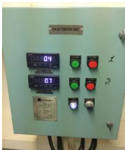
( Εικόνα 4.7 : μονάδα έλεγχου ροής έρματος )
