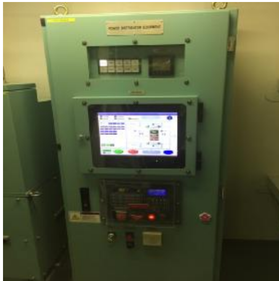
( Εικόνα 4.6 : μονάδα PDE με τοποθετημένη επάνω σε αυτή ο πίνακας έλεγχου )
