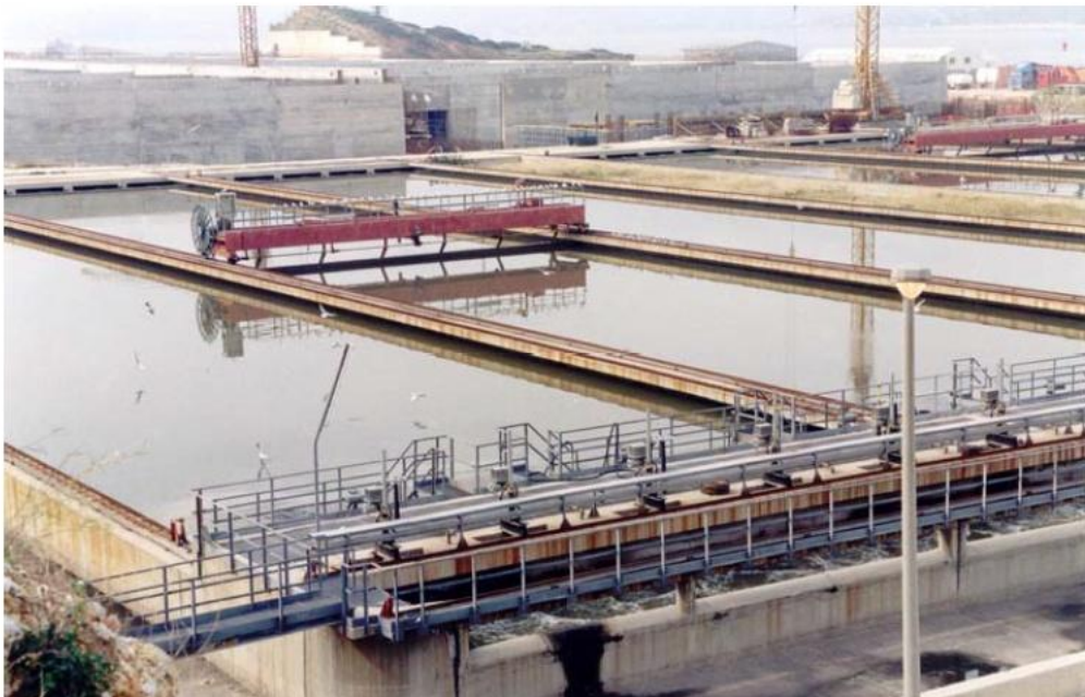
Εικόνα 2.3 Δεξαμενή πρωτοβάθμιας καθίζησης στη Μονάδα Επεξεργασίας Λυμάτων της Ψυττάλειας [6].
