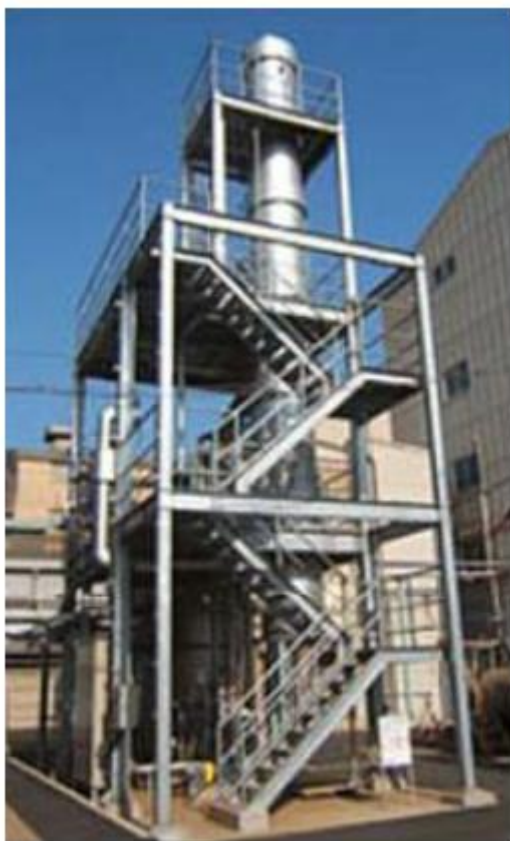
Εικόνα 4.2 πύργος απογύμνωσης της αμμωνίας [11].
