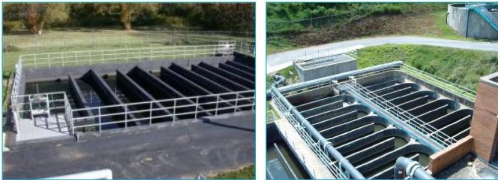
Εικόνα 2.12 Δεξαμενές χλωρίωσης σε μαιανδρική μορφή για την εξοικονόμηση χώρου [1].
