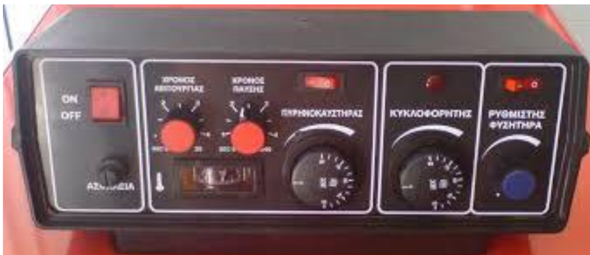
Εικόνα 3.1: Ηλεκτρικός πίνακας ελέγχου καυστήρα λέβητα της εταιρίας Thermostahl [7]
