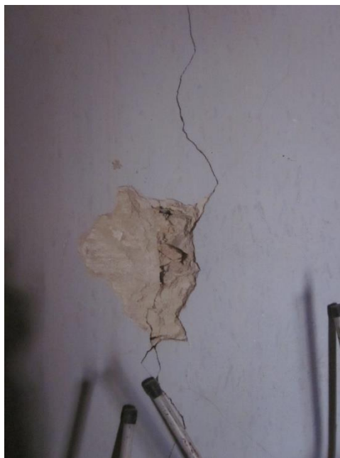
Εικόνα 3.1.2.1. Διάβρωση λόγω ρωγμής.
