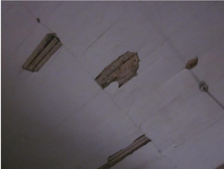
Εικόνα 3.1.3.1. Πτώση επιχρισμάτων οφειλόμενη σε υγρασία από την οροφή. Πρώτος όροφος.
