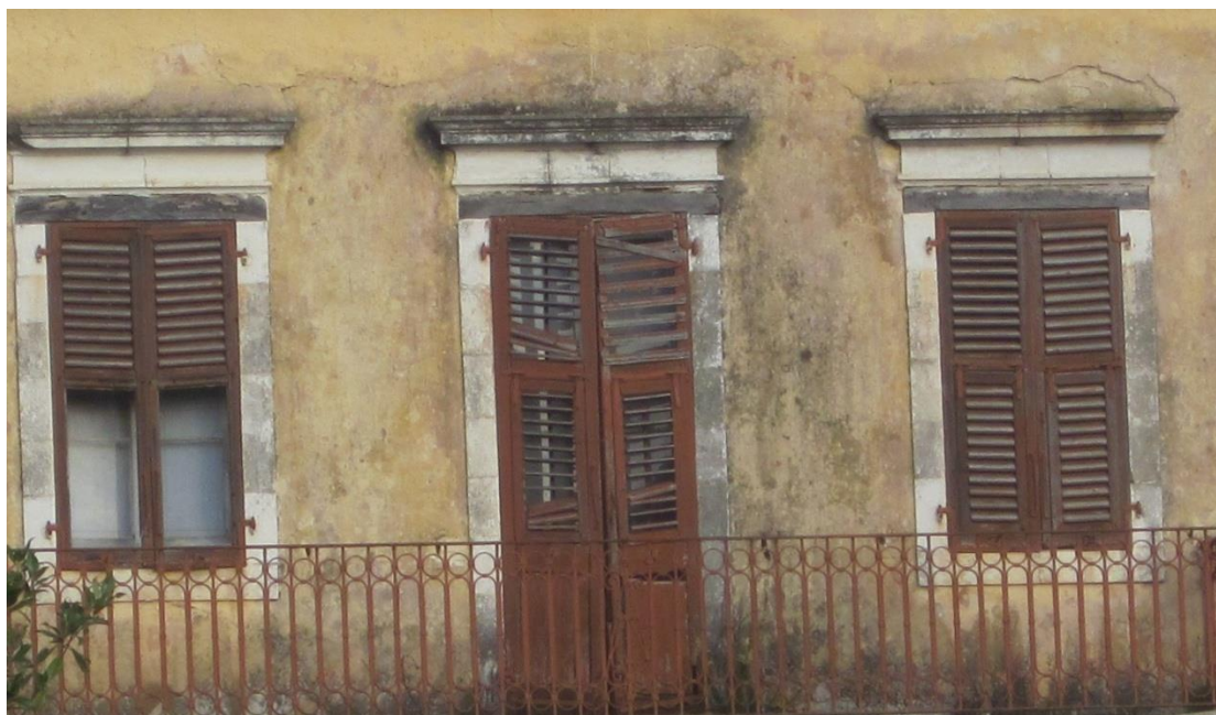
Εικόνα 3.1.1., 3.1.2. Αποτελέσματα υγρασίας (αλλοίωση χρωματισμού της εξωτερικής επιφάνειας).
