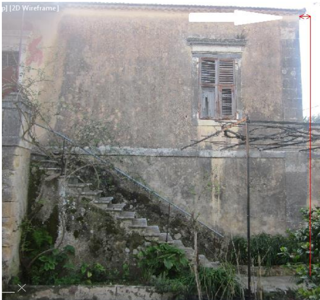
Εικόνα 2.1. Απεικόνιση παραμόρφωσης στο επάνω μέρος. Βόρειο – Δυτική πλευρά.
