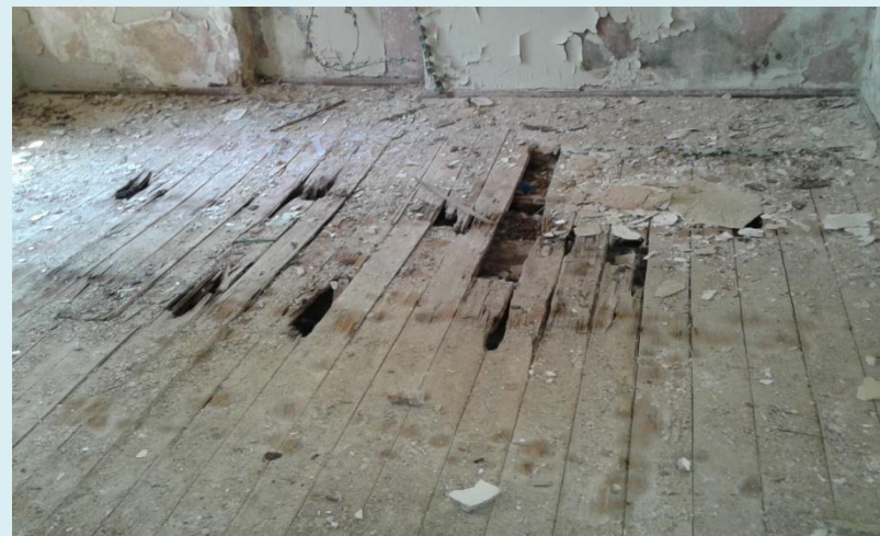
Εικ. 26 Φθαρμένα ξύλινα σανίδια στο δάπεδο του ισογείου
