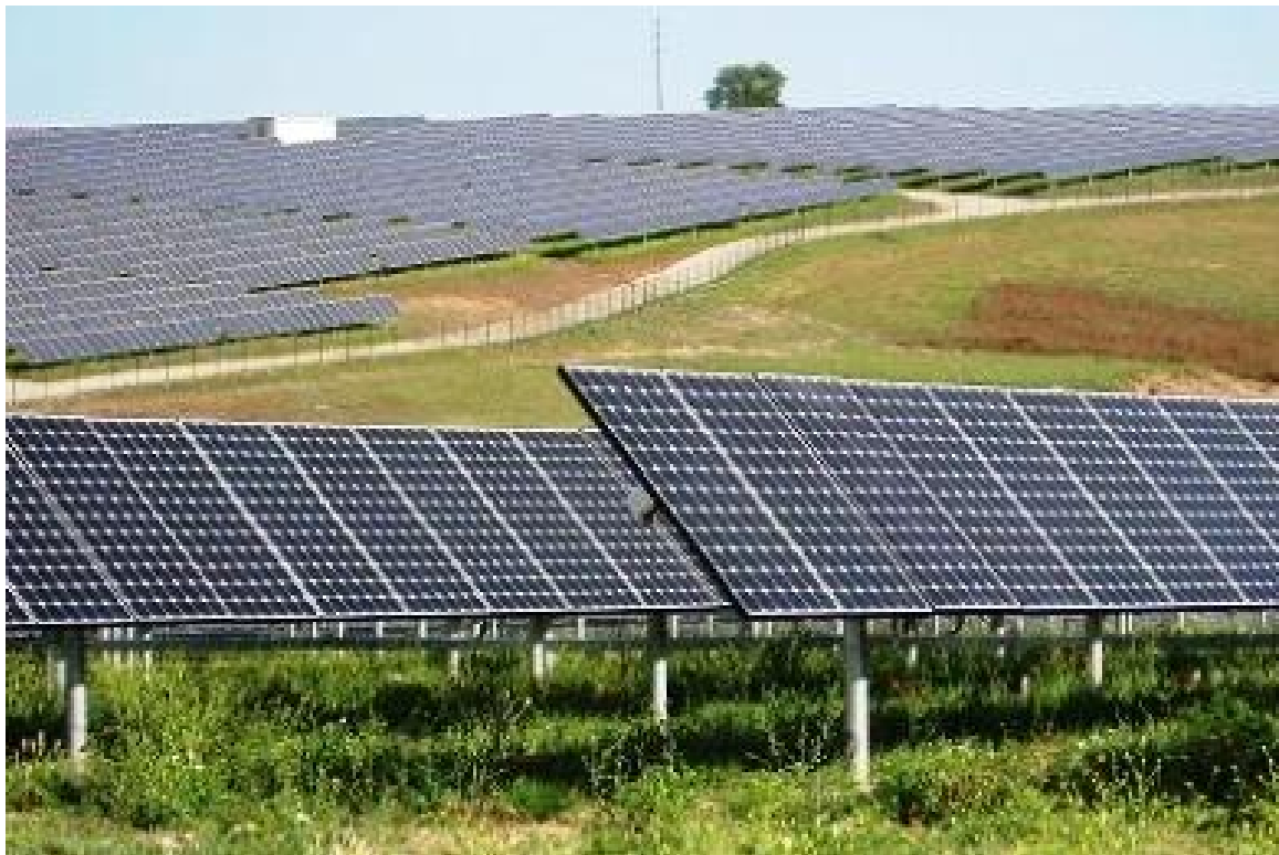
Σχήμα 2.4: Φωτοβολταϊκό πάρκο στο Κιλκίς, [15].
