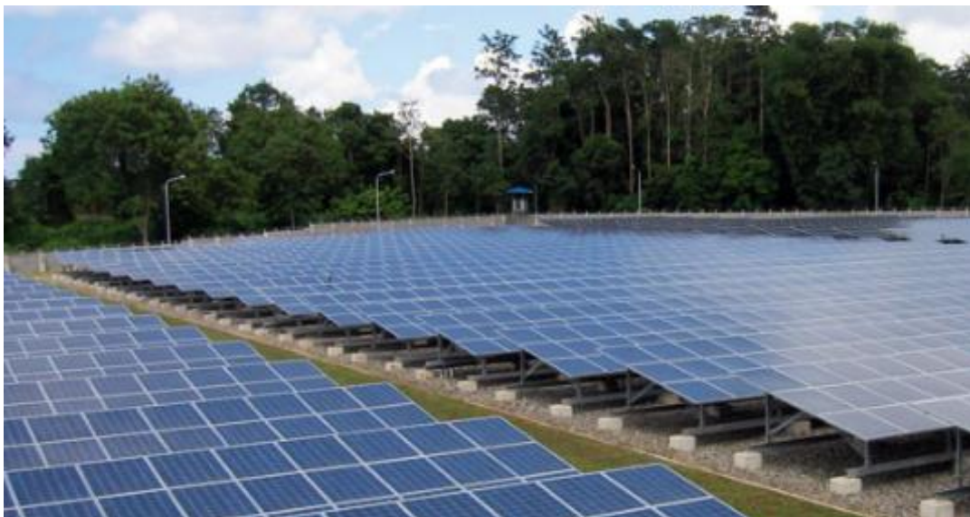
ΕΙΚΟΝΑ 26 : Φωτοβολταϊκός σταθμός ή φωτοβολταϊκό πάρκο
