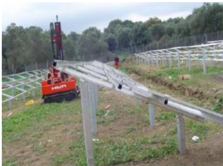
ΕΙΚΟΝΑ 53 : Σύστημα στήριξης φωτοβολταϊκών πλαισίων
