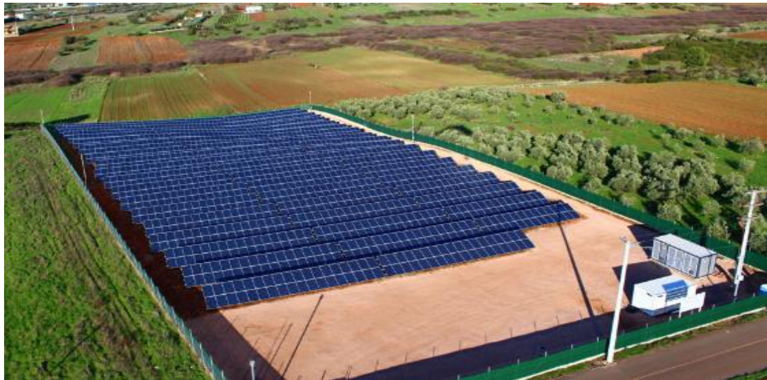
ΕΙΚΟΝΑ 6 : Φωτοβολταϊκό πάρκο
