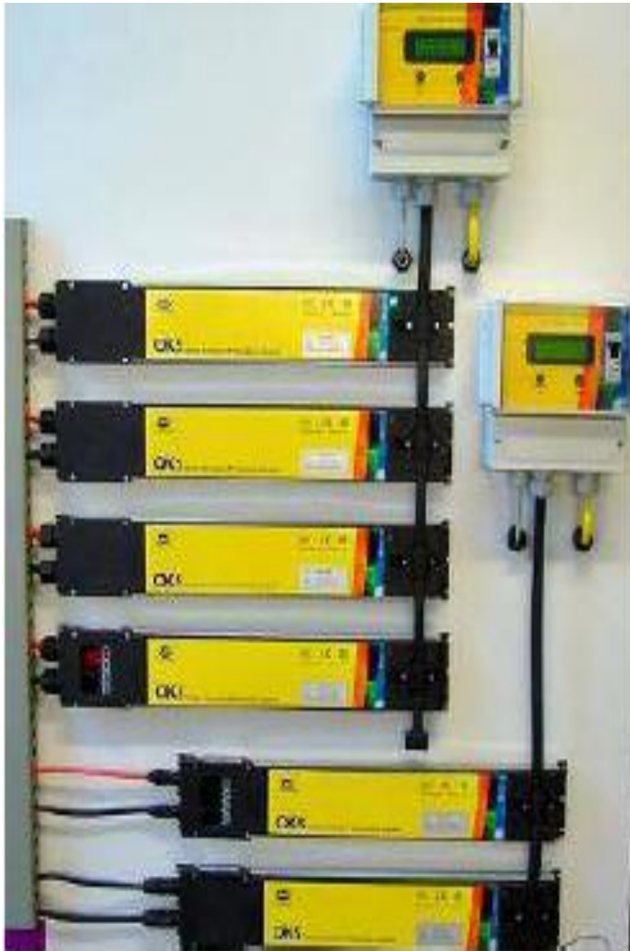
ΕΙΚΟΝΑ 37 : Αντιστροφείς ενσωματωμένοι σε φωτοβολταϊκό πάνελ
