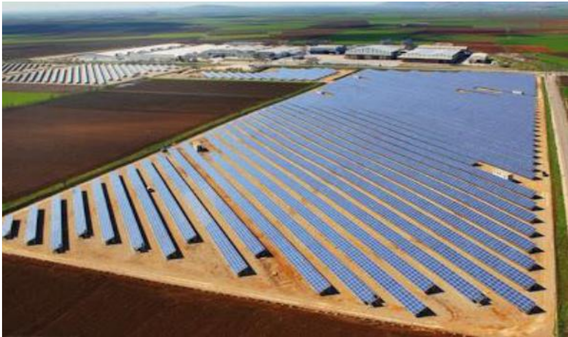
ΕΙΚΟΝΑ 60 : Φωτοβολταϊκό πάρκο στα Φάρσαλα. Στην φωτογραφία φαίνεται μόνο ένα μέρος του πάρκου. Πηγή http://charikliavlachaki.blogspot.gr/
