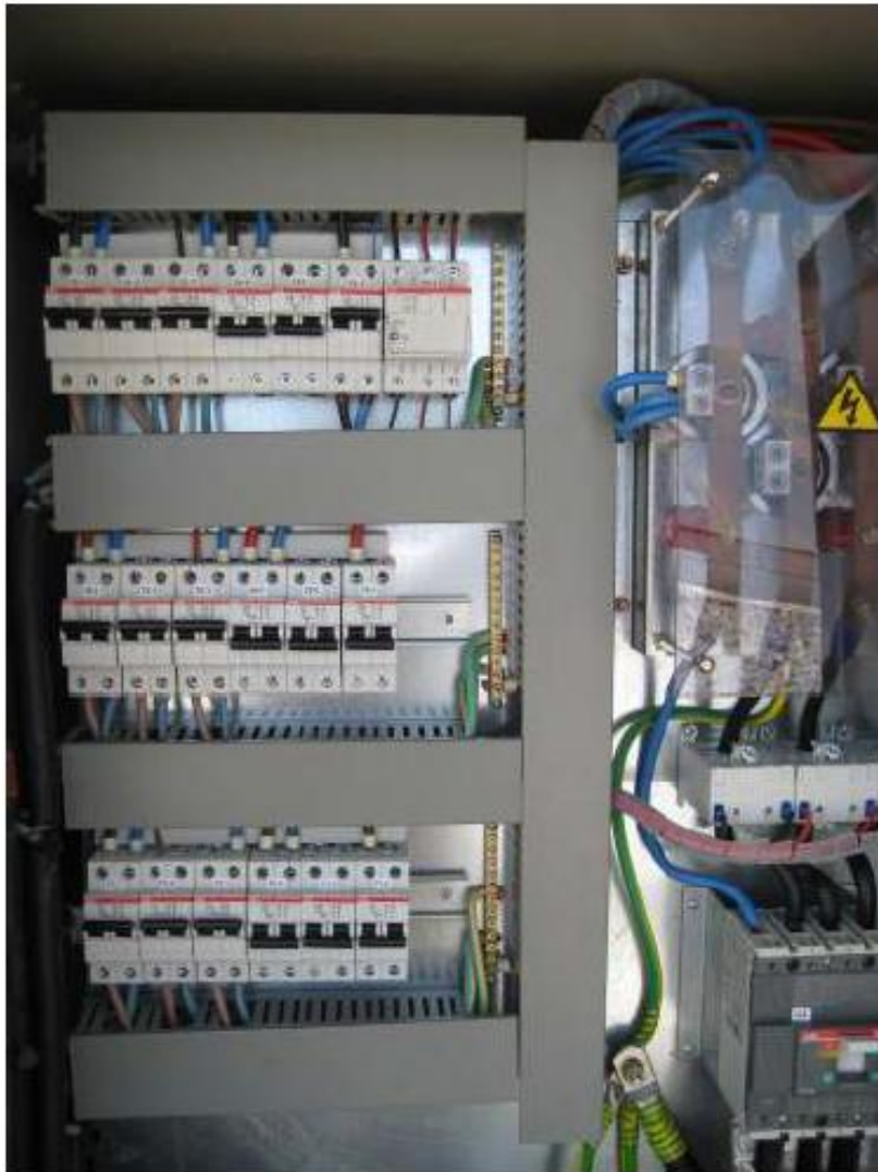
ΕΙΚΟΝΑ 57 : Τριφασικός πίνακας φωτοβολταϊκής εγκατάστασης
