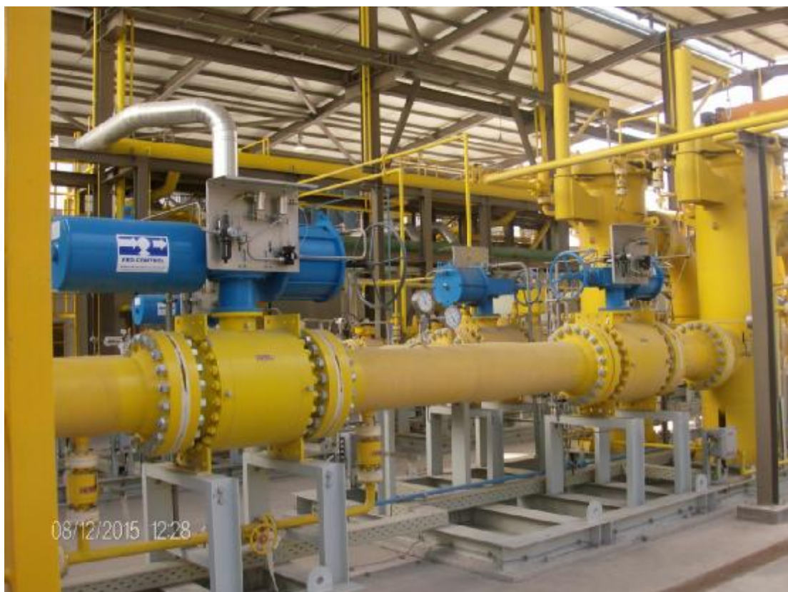
Σταθμός ρύθμισης φυσικού αερίου
