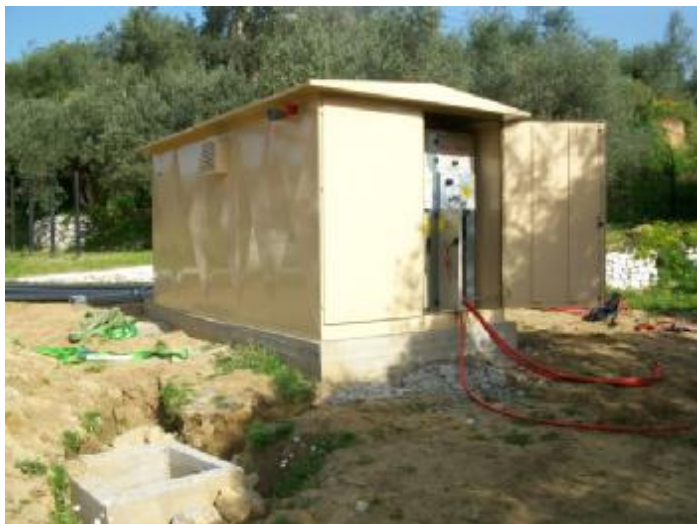
Εικόνα 1. Υποσταθμός μέσης τάσης εσωτερικού χώρου
