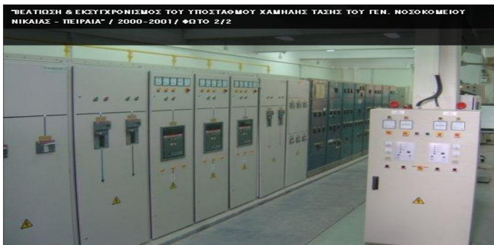
Εικόνα 5: Εσωτερικό μέρος υποσταθμού ΧΤ Νοσοκομείου
