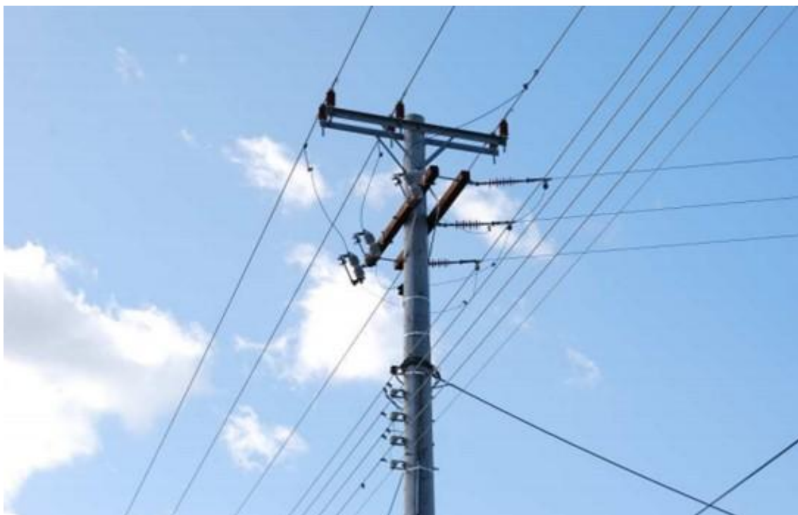
Εικόνα 9: Γραμμή μέσης τάσης στη περιοχή της Πάτρας, στον ίδιο στύλο είναι αναρτημένη και η γραμμή χαμηλής τάσης
