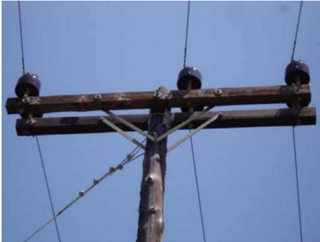
Εικόνα 10: Ξύλινος πυλώνας με ξύλινη τραβέρσα. Με μονωτήρες για την στήριξη των γυμνών αγωγών μιας γραμμής μέσης τάσης. Διακρίνεται και η πρόσδεση του επιτόνου στο στύλο.
