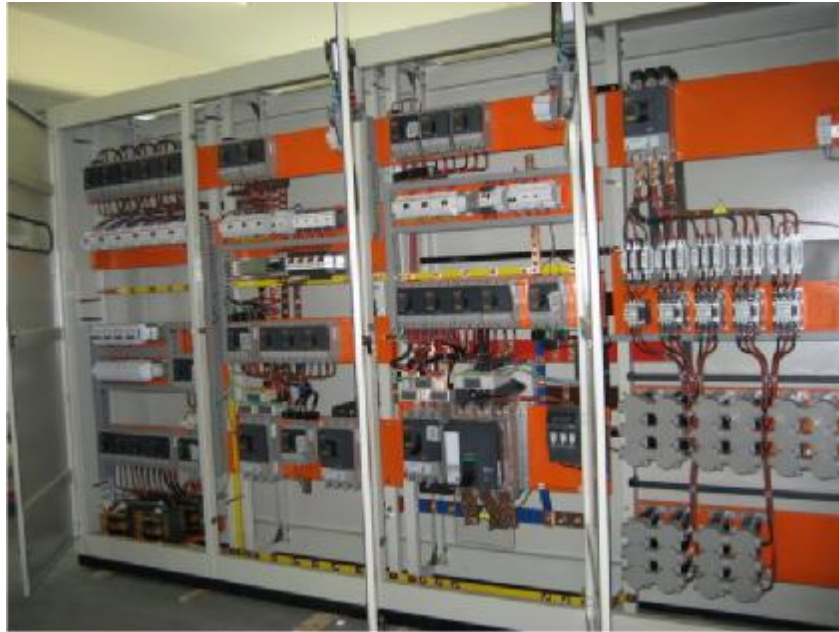
Εικόνα 18: Πίνακας Χαμηλής Τάσης – Εξωτερική άποψη
