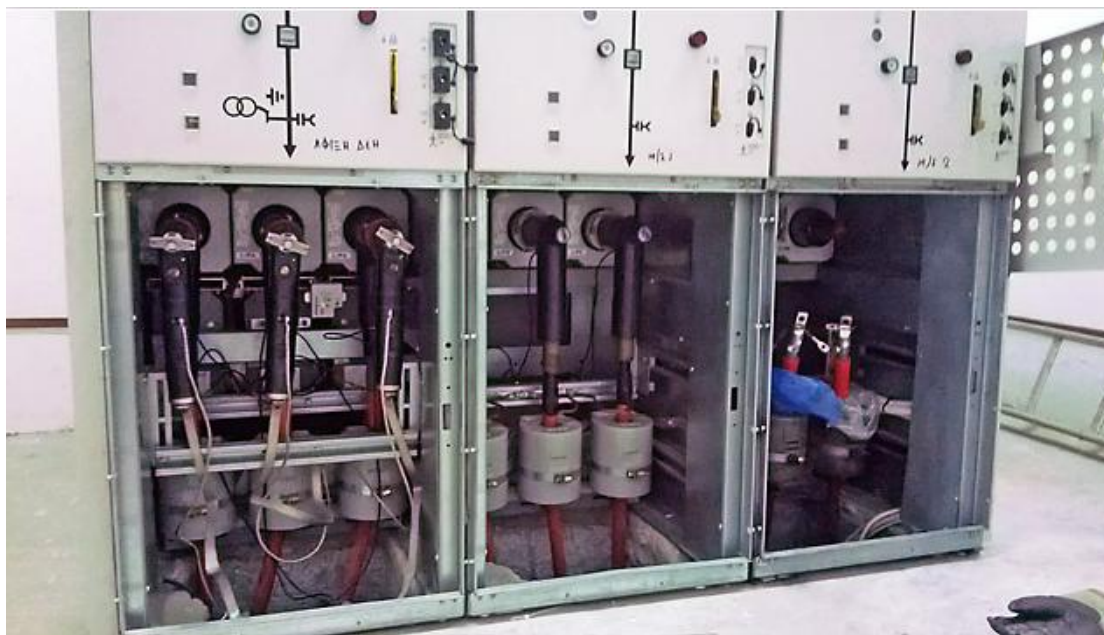
Εικόνα 16: Πίνακας Μέσης Τάσης- Εσωτερική ‘Αποψη
