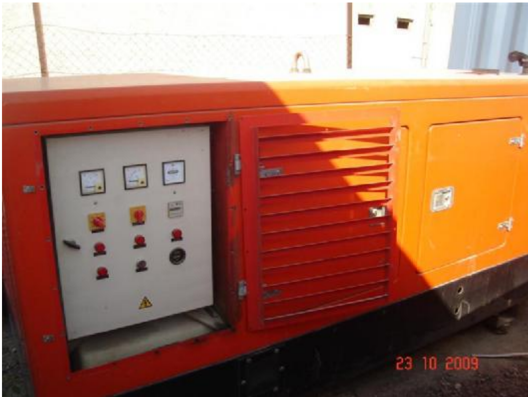
Εικόνα 4: Ο Ηλεκτρικός Πίνακας του H/Z
