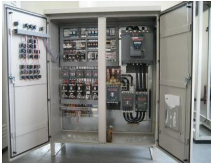
Εικόνα 20: Πίνακας Τύπου PILLAR – Εσωτερική Συνδεσμολογία
