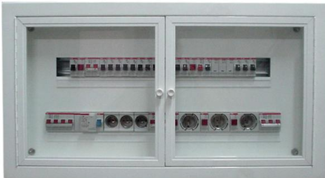
Εικόνα 23: Χωνευτός Ηλεκτρικός Πίνακας
