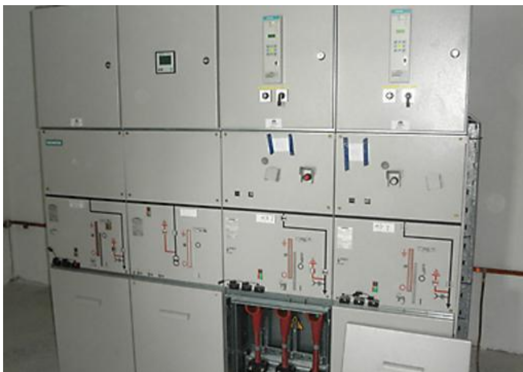
Εικόνα 15 : Πίνακας Μέσης Τάσης – Εξωτερική Άποψη
