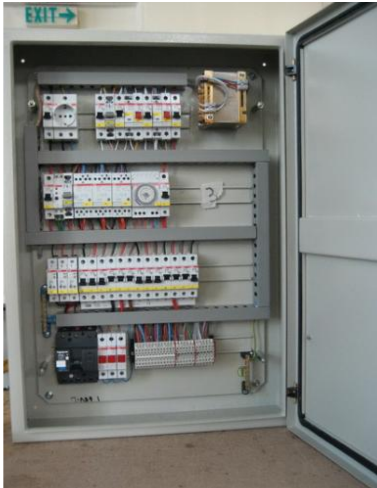
Εικόνα 22: Επίτοιχος Ηλεκτρικός Πίνακας – Ηλεκτρική Συνδεσμολογία
