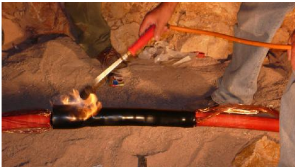
Εικόνα 37: Τερματισμός και σύνδεση καλωδίων μέσης τάσης
