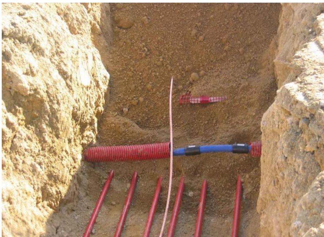
Εικόνα 34: Οδευση καλωδίων μέσης τάσης εντός του εδάφους
