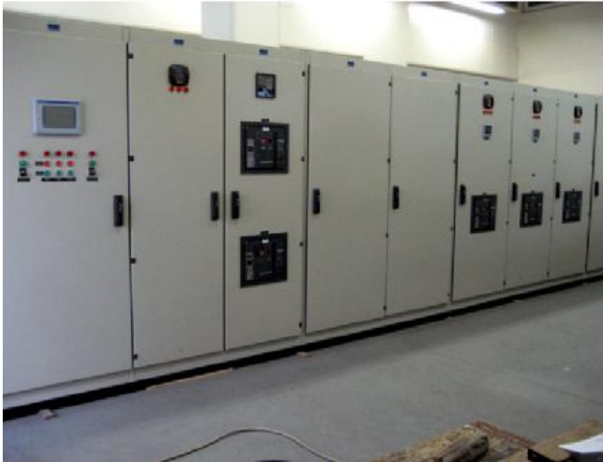
Εικόνα 17: Πίνακας Χαμηλής Τάσης – Εξωτερική άποψη
