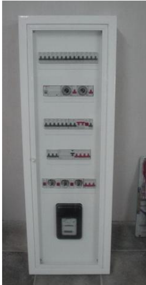
Εικόνα 24: Επίτοιχος Ηλεκτρικός Πίνακας
