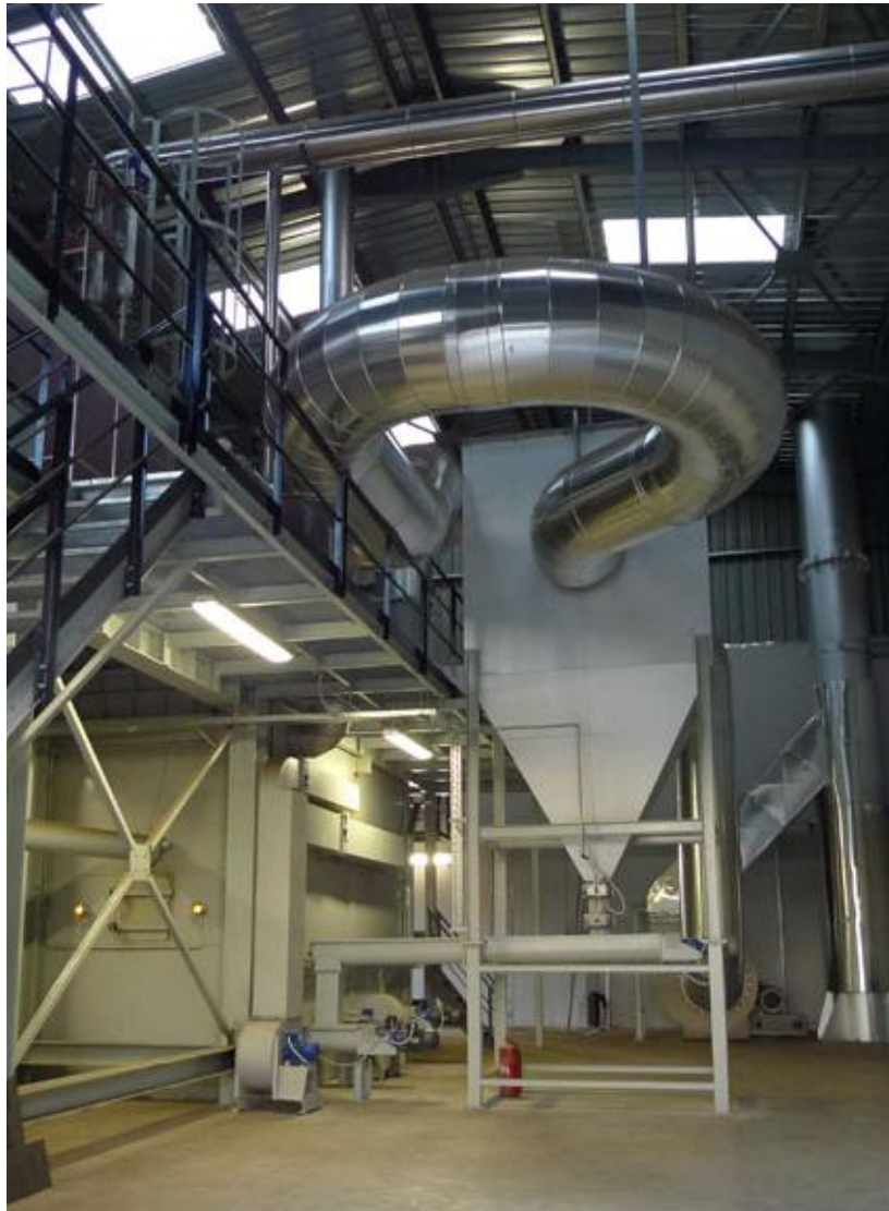
Εικόνα 4.6: Σιλό αποθήκευσης στάχτης
