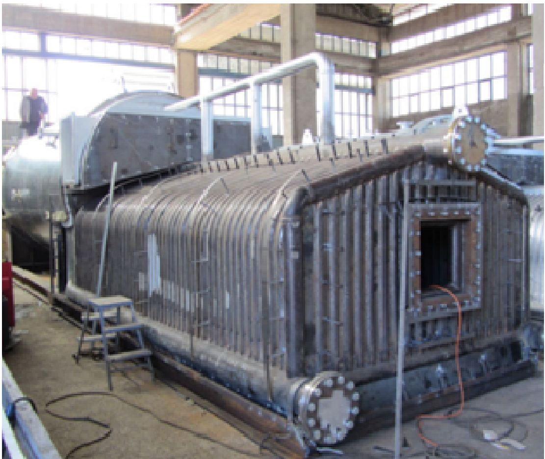
Εικόνα 4.1: Σύστημα παραγωγής κορεσμένου ατμού με χρήση βιομάζας
