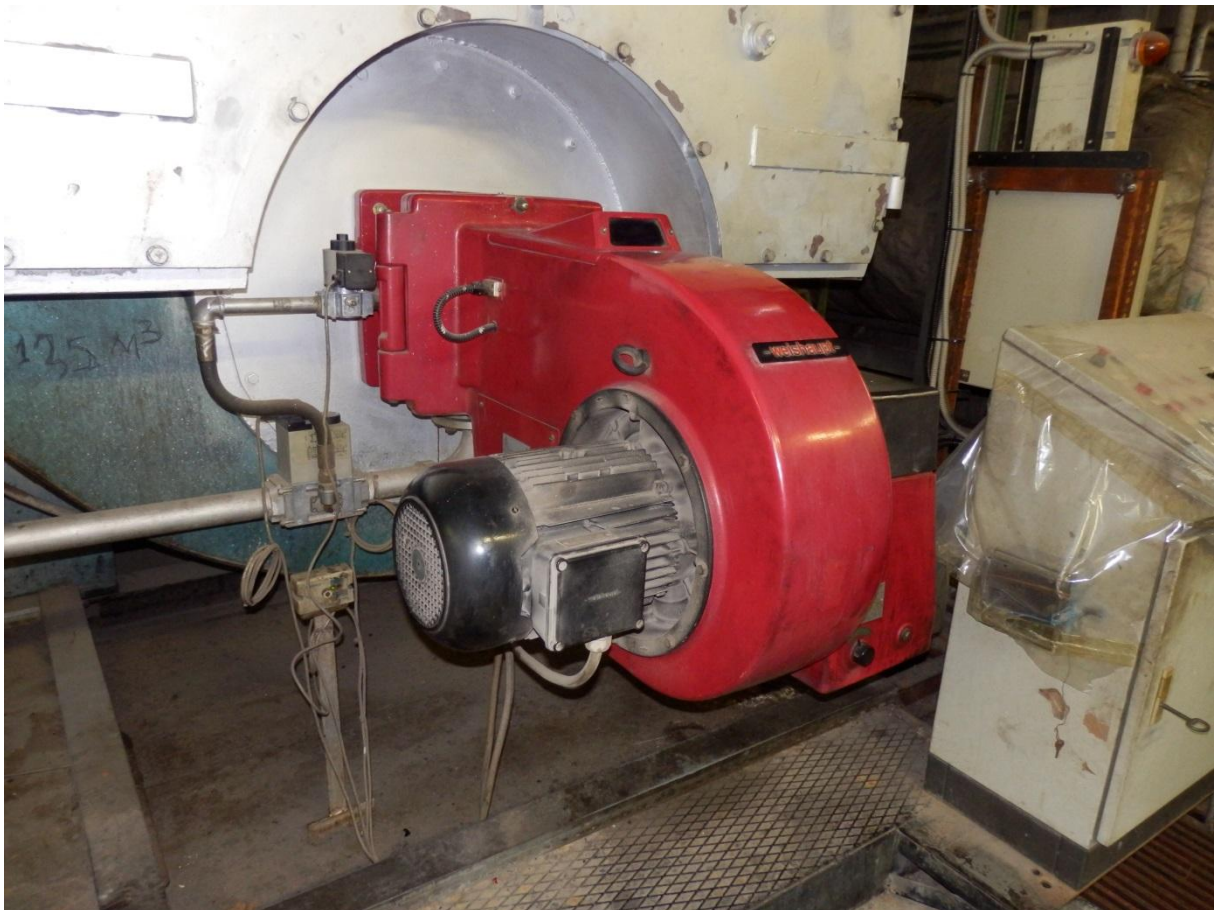
Εικόνα 2.2.: Καυστήρας της εγκατάστασης
