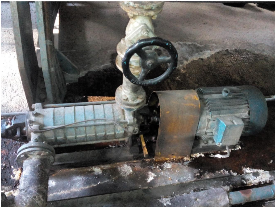
Εικόνα 2.20: Αντλία τροφοδοσίας νερού
