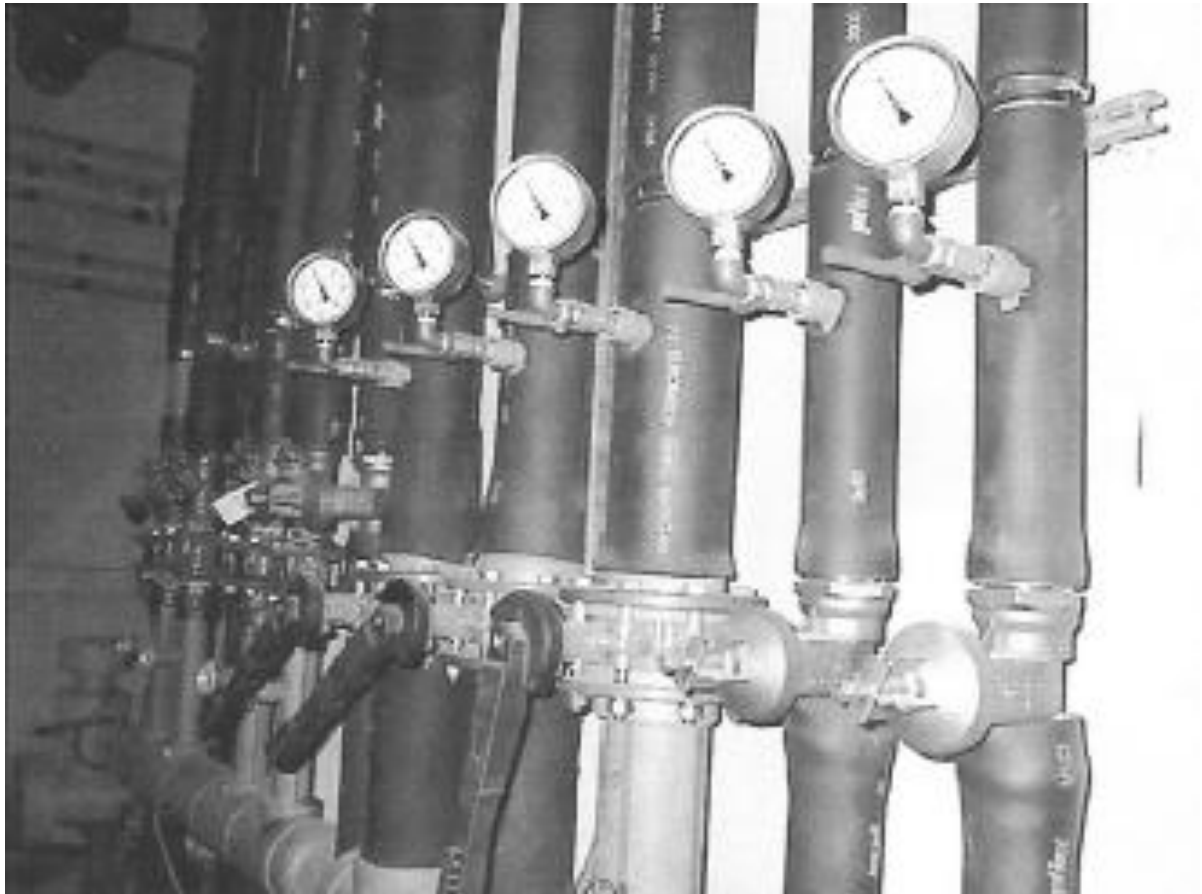
Εικόνα 4.5 Θερμομόνωση σωληνώσεων θερμού νερού. [www.google.gr/search]
