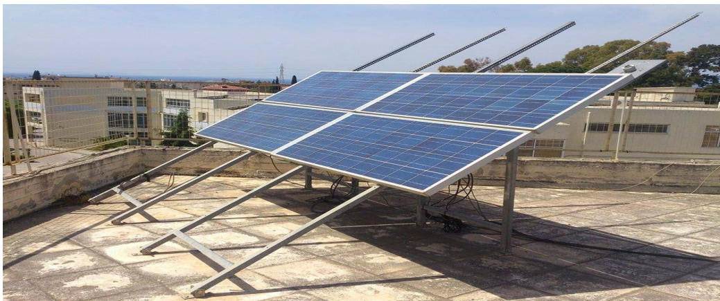
Εικόνα 2.27: φωτοβολταϊκή γεννήτρια με σταθερή κλίση (Fixed) στο εργαστήριο ΑΠΕ, ΤΕΙ Δυτικής Ελλάδας
