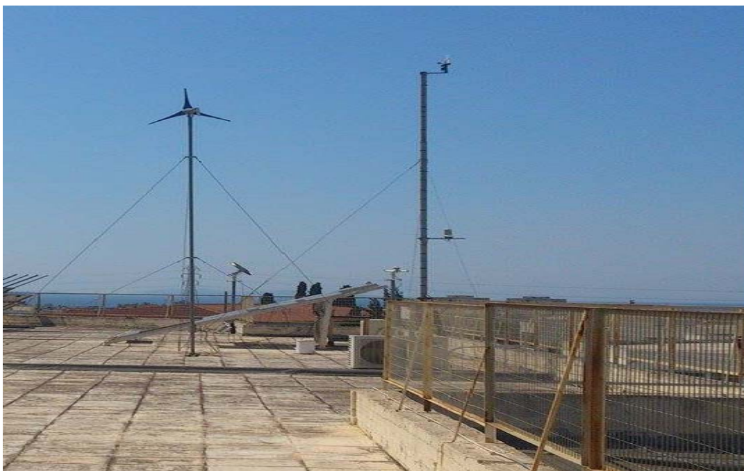
Εικόνα 2.26: Υβριδικό φωτοβολταϊκό σύστημα στο εργαστήριο ΑΠΕ, ΤΕΙ Δυτικής Ελλάδας
