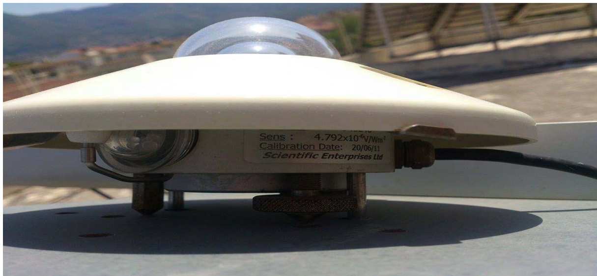
Εικόνα 1.20: Πυρανόμετρο τοποθετημένο στην σταθερή φωτοβολταϊκή γεννήτρια (Fixed) στο εργαστήριο των ΑΠΕ, ΤΕΙ Δυτικής Ελλάδας
