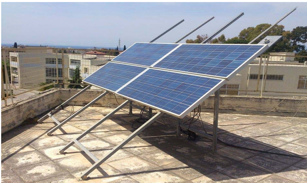
Εικόνα Ε8: Φωτοβολταϊκή εγκατάσταση σταθερού προσανατολισμού για εκμετάλλευση ηλιακής ενέργειας εργαστήριο ΑΠΕ, ΤΕΙ Δυτικής Ελλάδας
