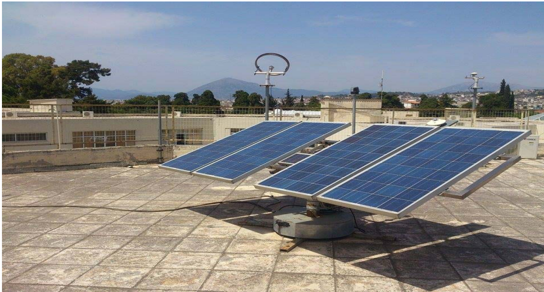
Εικόνα 4.2:Κινητή διαξονική φωτοβολταϊκή γεννήτρια (Tracker) στο εργαστήριο των ΑΠΕ ΤΕΙ Δυτικής Ελλάδας
