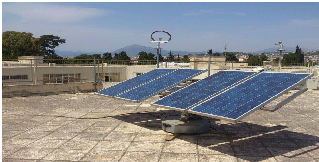
Εικόνα 2.28: φωτοβολταϊκή εγκατάσταση με συστήματα tracking στο εργαστήριο ΑΠΕ, ΤΕΙ Δυτικής Ελλάδας
