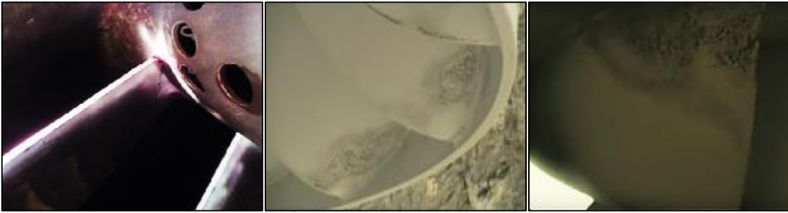
Εικόνα 71 (α).Ρωγμή σταθερού περηνγίου στην βάση του (β).σηηλαίωση στο τελείωμα του περηνγίου[πηγή: youtube.com/watch?v]
