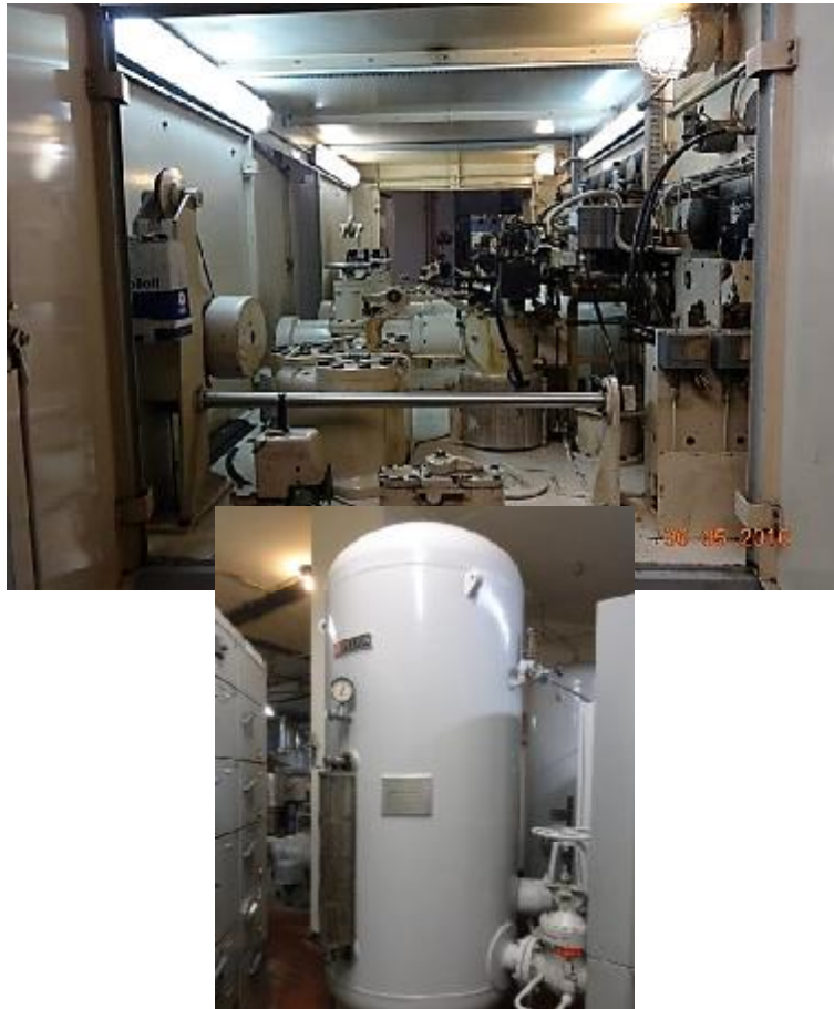
Εικόνα 108. Μηχανισμός ρυθμιστή στροφών. Δεξαμενή αέρα και ελαίου υψηλής πίεσης [πηγή: ΔΕΗ Α.Ε]
