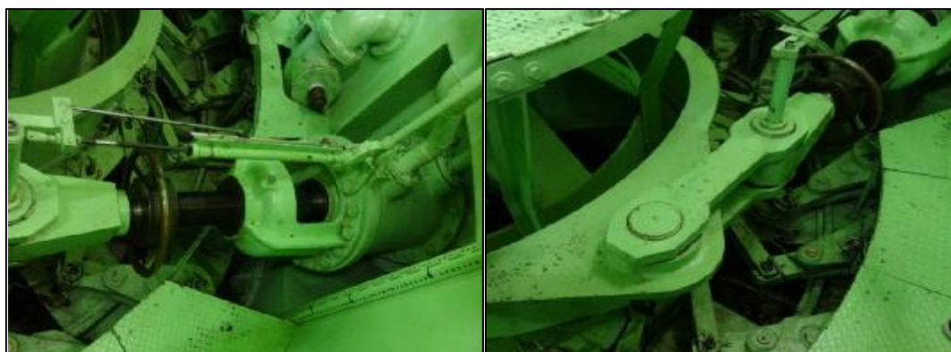
Εικόνα 44 Σύστημα Σερβομοτέρ με τα κινητά πτερύγια. [πηγή: αρχείο ΥΗΣ Καστρακίου]
