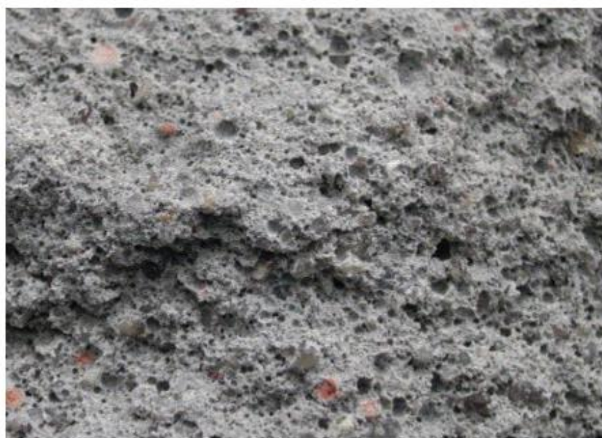
Εικόνα 7.2. Μεγέθυνση τομής σκυροδέματος στην οποία φαίνονται οι φυσαλίδες αέρα στο εσωτερικό του.
