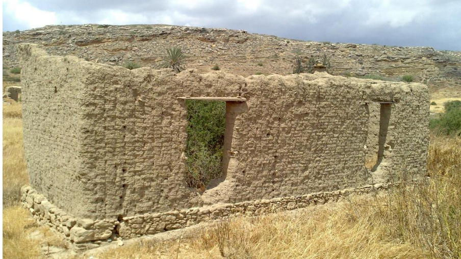
Εικ.16 σημερινή κατάσταση του κτηρίου στο οικόπεδο 102 όπου απουσιάζουν τα κουφώματα, η στέγη , το δάπεδο κα.
