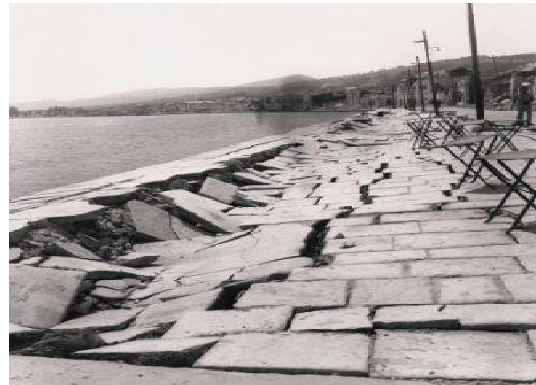
19. Το λιμάνι του Αργοστολίου μετά τον σεισμό.
