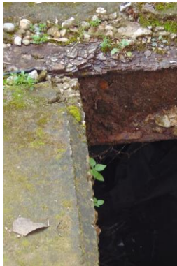
Φ.124 Λεπτομέρεια δεξαμενής στο χώρο A4
