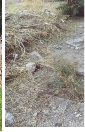
Φ.168 Λεπτομέρεια δεξαμενών εξωτερικά του κτηρίου
