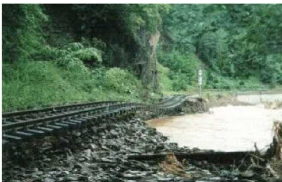
Εικόνα 33. Απεικόνιση περίπτωσης καθίζησης λόγω βαλτωδών εδαφών και καταστροφή της σιδηροδρομικής γραμμής [9]
