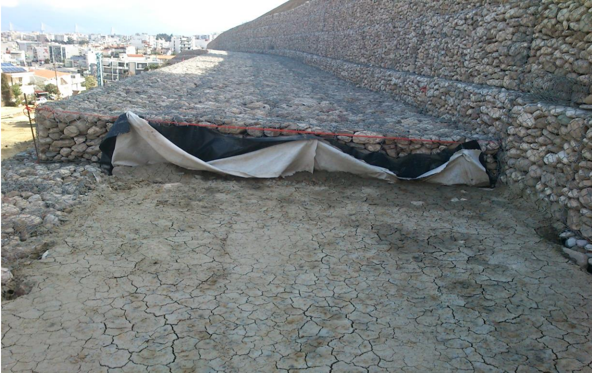
Εικόνα 3.10 Ο δεύτερος τοίχος σαραζανέτ στη φάση κατασκευής. Διακρίνεται και η μόνωση που εφαρμόστηκε στην επιφάνεια του εδάφους.
