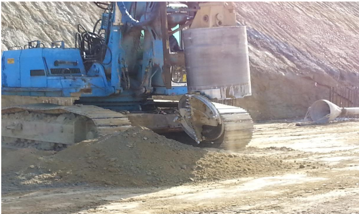
Εικόνα 4.1 Ο κυλινδρικός κάδος με ανοικτή θύρα κατά την αποδέσμευση του εδαφικού υλικού. Διακρίνεται το κάτω μέρος του με τις προεξοχές και τις εγκοπές του που συμβάλουν στην διάτρηση και τη δέσμευση του εδαφικού υλικού.
