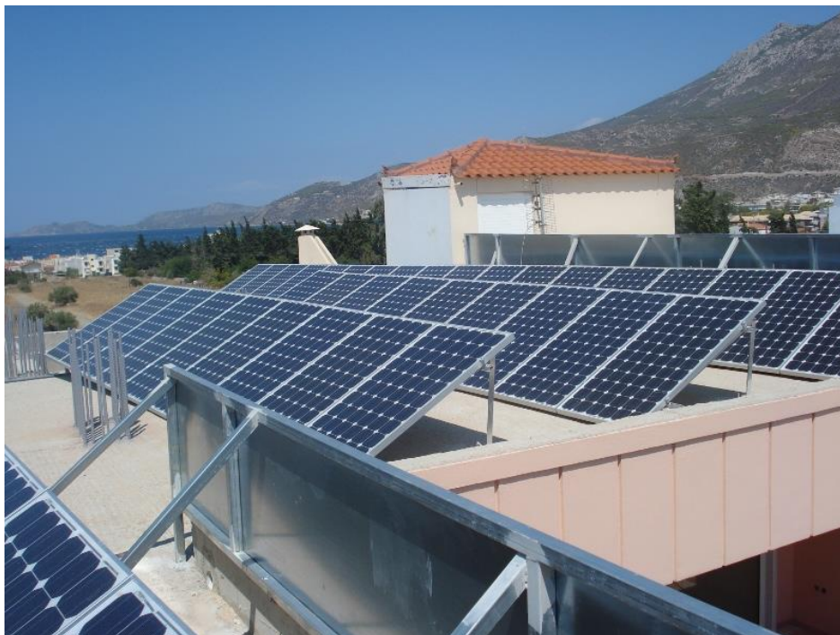
Εικόνα 33. Εγκατεστημένο φωτοβολταϊκό σύστημα σε φυτεμένο δώμα
