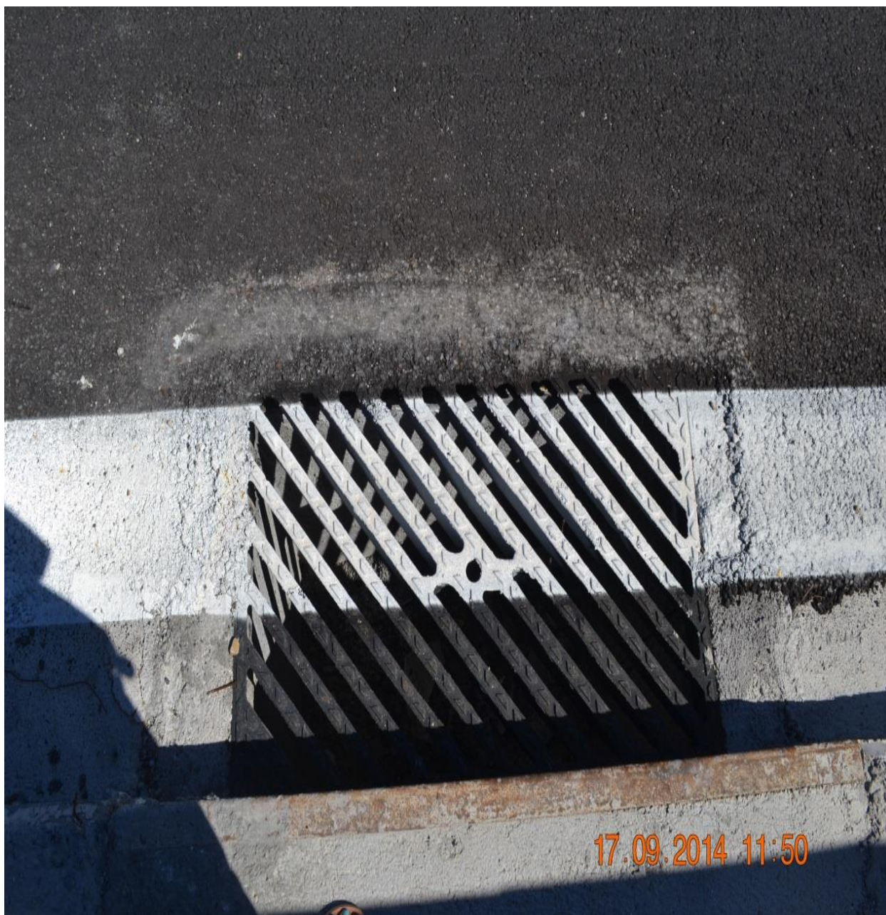
Φωτ. 6.23 Φρεάτιο περισυλλογής ομβρίων υδάτων, για την ασφαλή απορροή τους.
