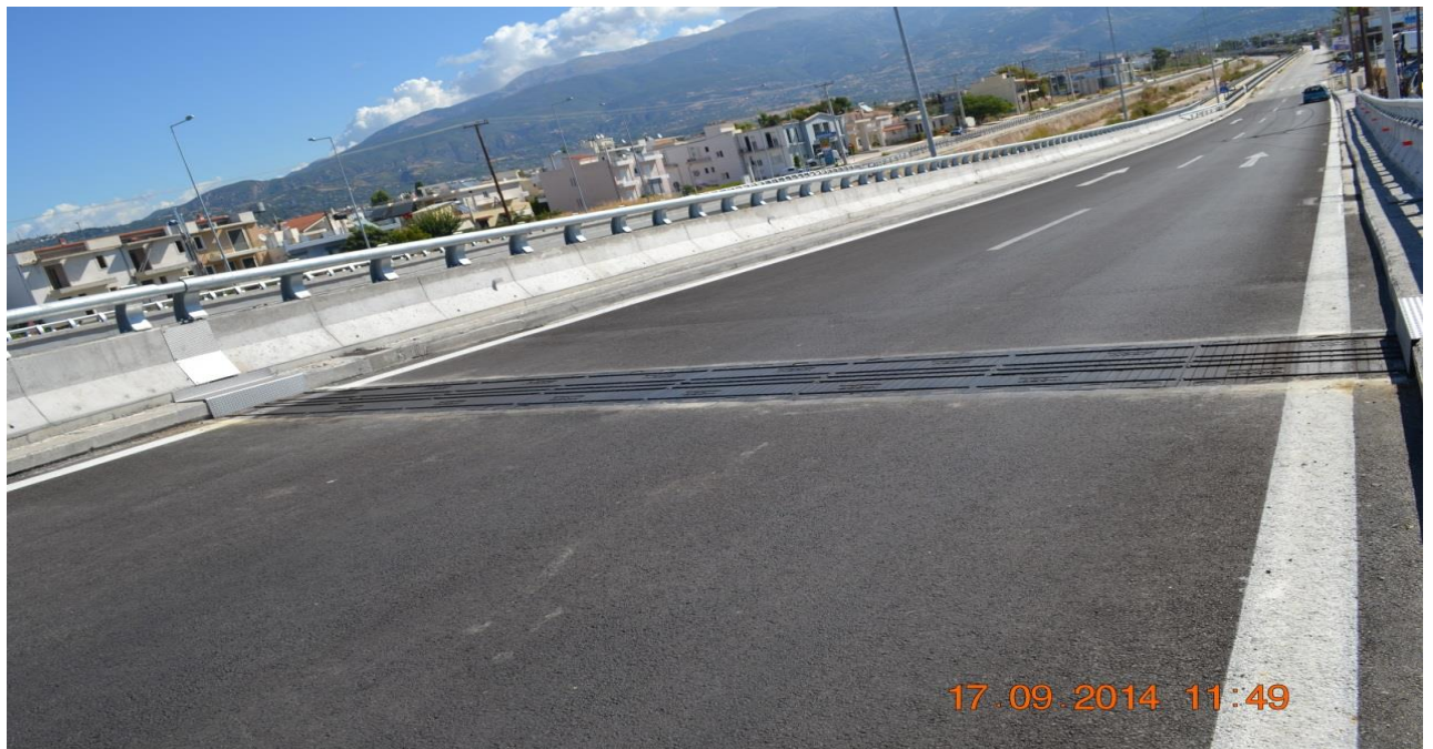
Φωτ. 6.22 Αρμός συστολοδιαστολής του καταστρώματος στη θέση του ακρόβαθρου Α2Δ τύπου ALGAFLEX T330AS με ικανότητα μετακίνησης \pm 165\text{mm} .
