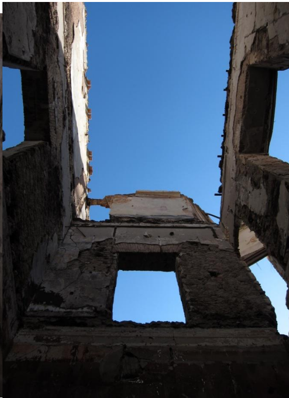
Εικόνα 49 - έντονες φθορές και κατάρρευση τμημάτων.
