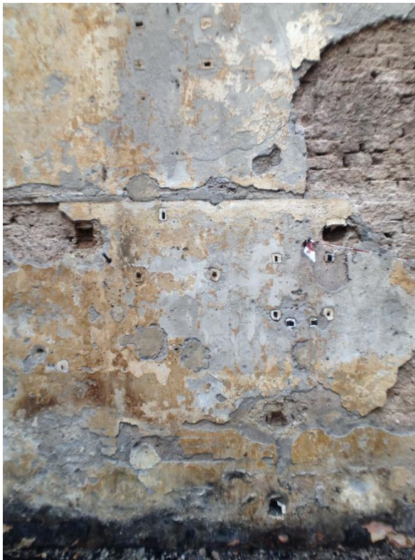
Εικόνα 50 - Καθαίρεση επιχρίσματος και ένδειξη δοκοθηκών.
