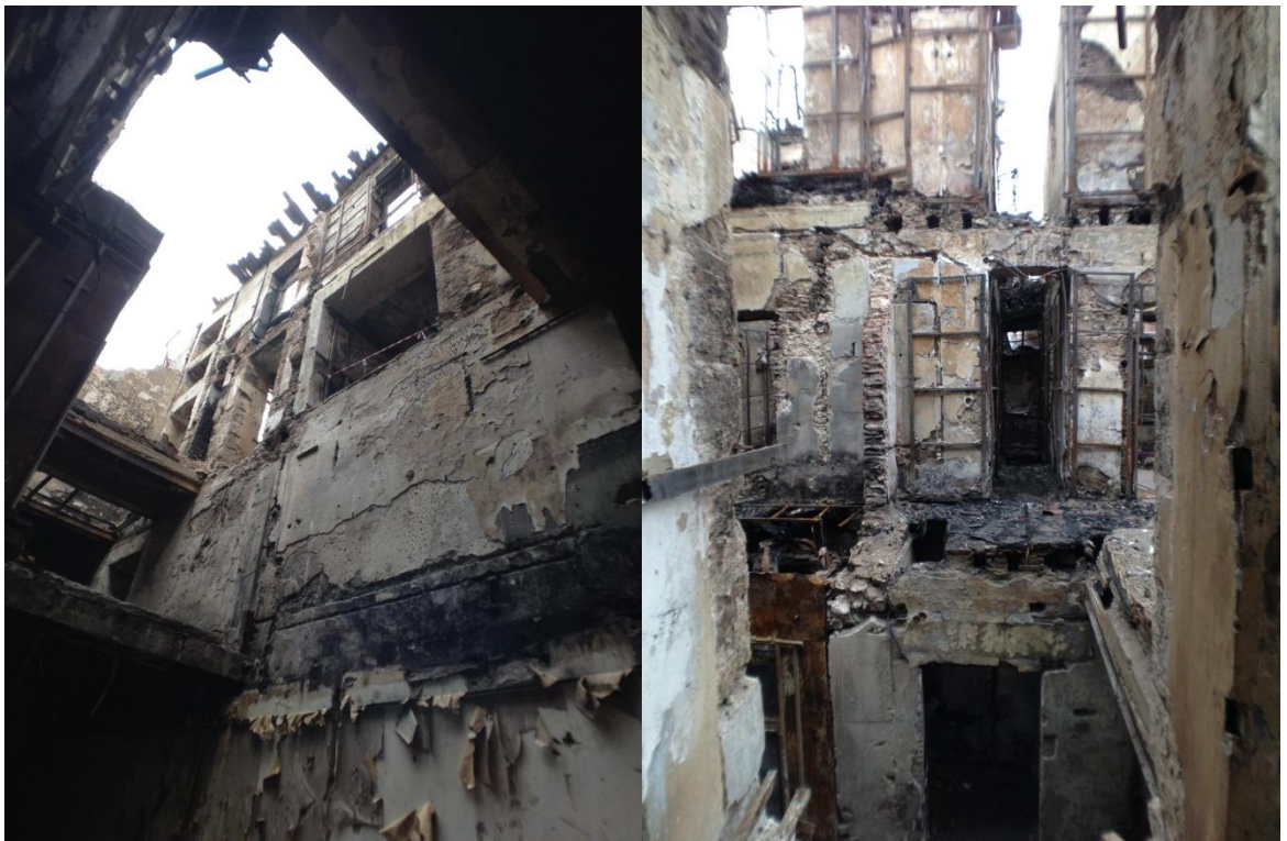
Εικόνα 38 - Αποφλοίωση και απολέπιση επιχρίσματος. Εικόνα 39 - Άποψη εσωτερικής τοιχοποιίας.
