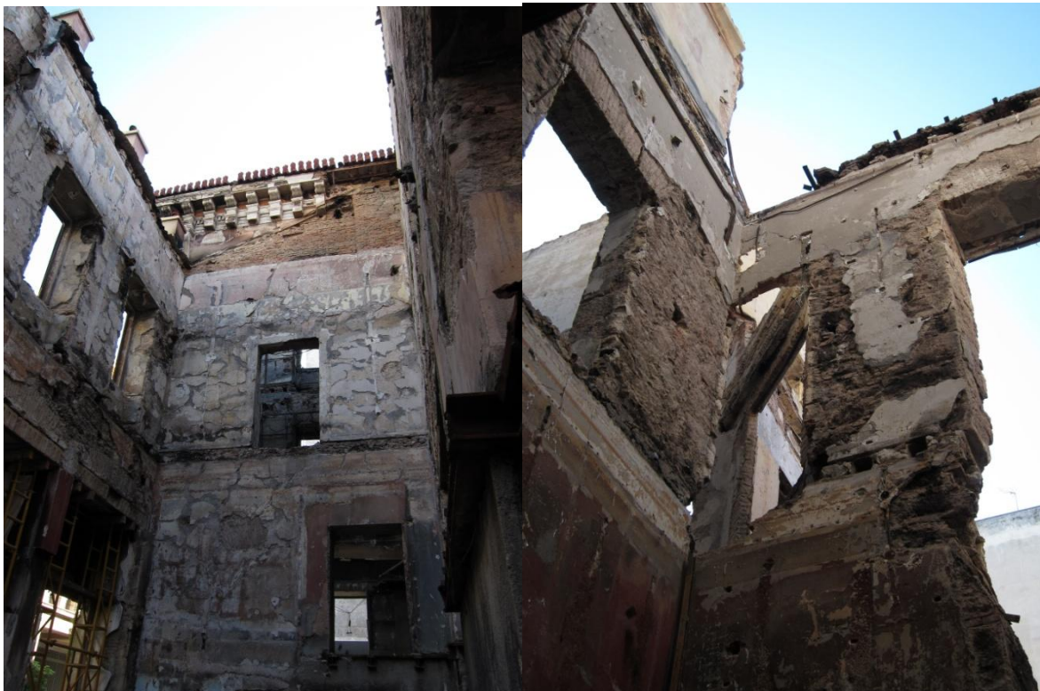
Εικόνα 46 - Άποψη τοιχοποιίας α,β επιπέδων και στέγης. Εικόνα 47 - Κατάρρευση τμήματος τοιχοποιίας.
