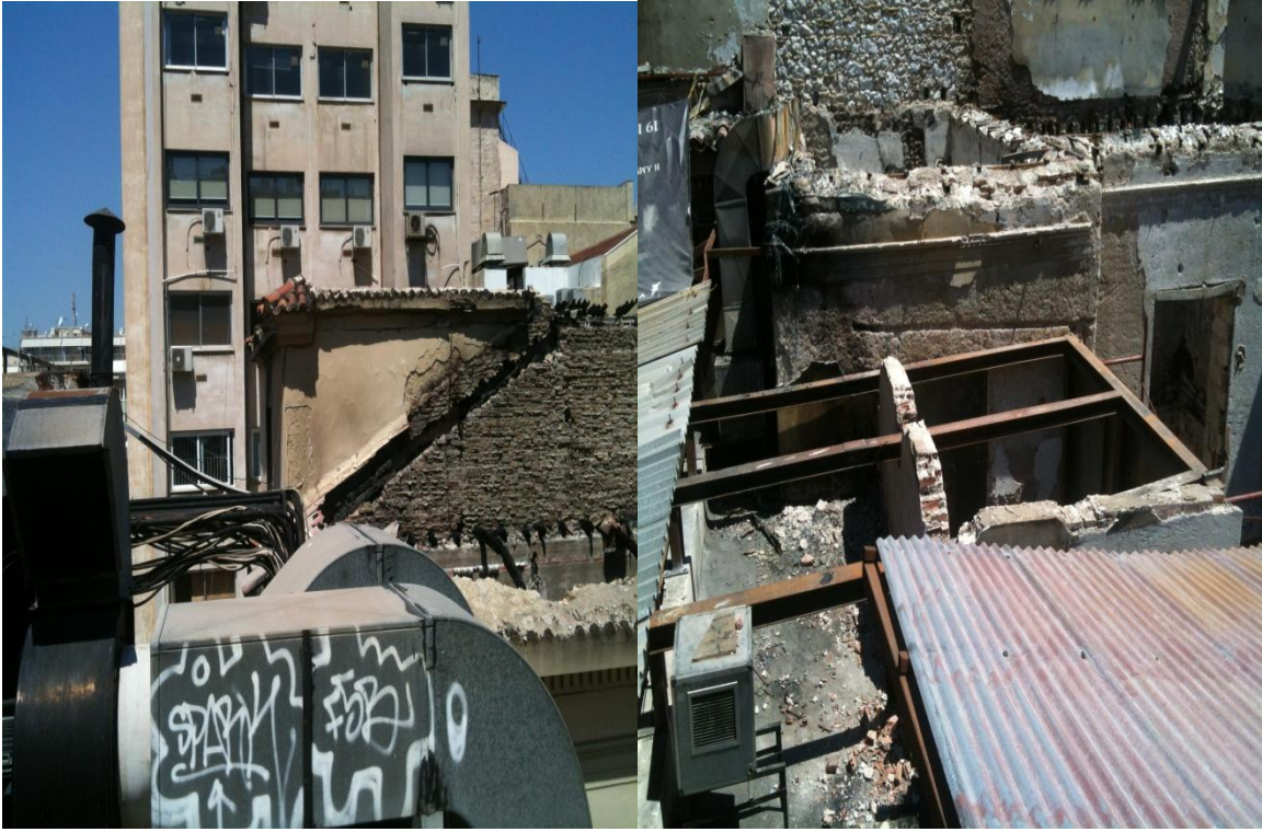
Εικόνα 51 - Άποψη τμήματος κατεστραμμένης στέγης. Εικόνα 52 - Άποψη στέγης κατώτερου επιπέδου.
