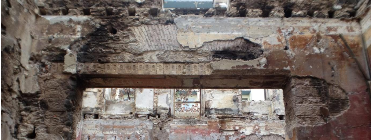
Εικόνα 21 - Καταστροφή επιχρίσματος, εκτίναξη λίθων και οπτόπλινθων
