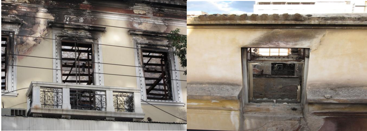
Εικόνα 19 - Αποφλοιώση απολέπιση εξωτερικής τοιχοποιίας Εικόνα 20 - Ρηγματώση στην εξωτερική τοιχοποιία
