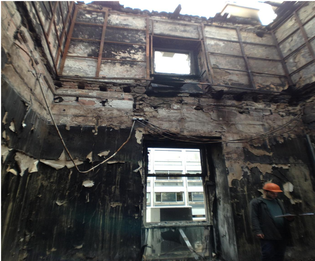
Εικόνα 28 - Άποψη κατεστραμμένων ηλεκτρολογικών εγκαταστάσεων.
