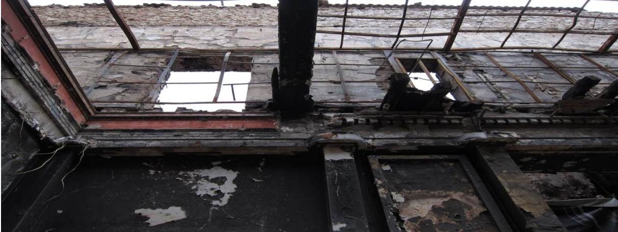
Εικόνα 13 - Άποψη υπολειμμάτων ξύλινων δοκαριών στα δάπεδα και μεταλλικών δοκαριών (σενάζ)
