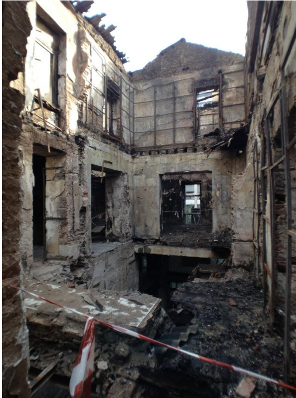
Εικόνα 40 - Τμήμα κατεστραμμένης τοιχοποιίας.
