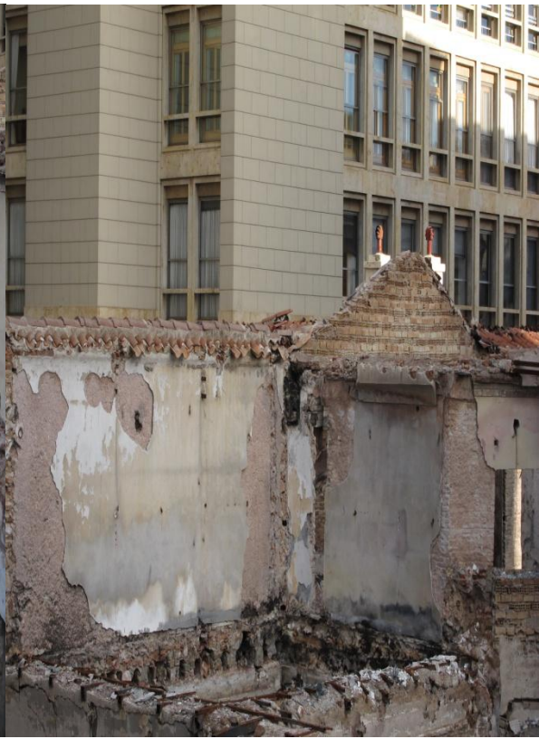
Εικόνα 58 - Τμήμα κατεστραμμένης τοιχοποιίας και στέγης.
