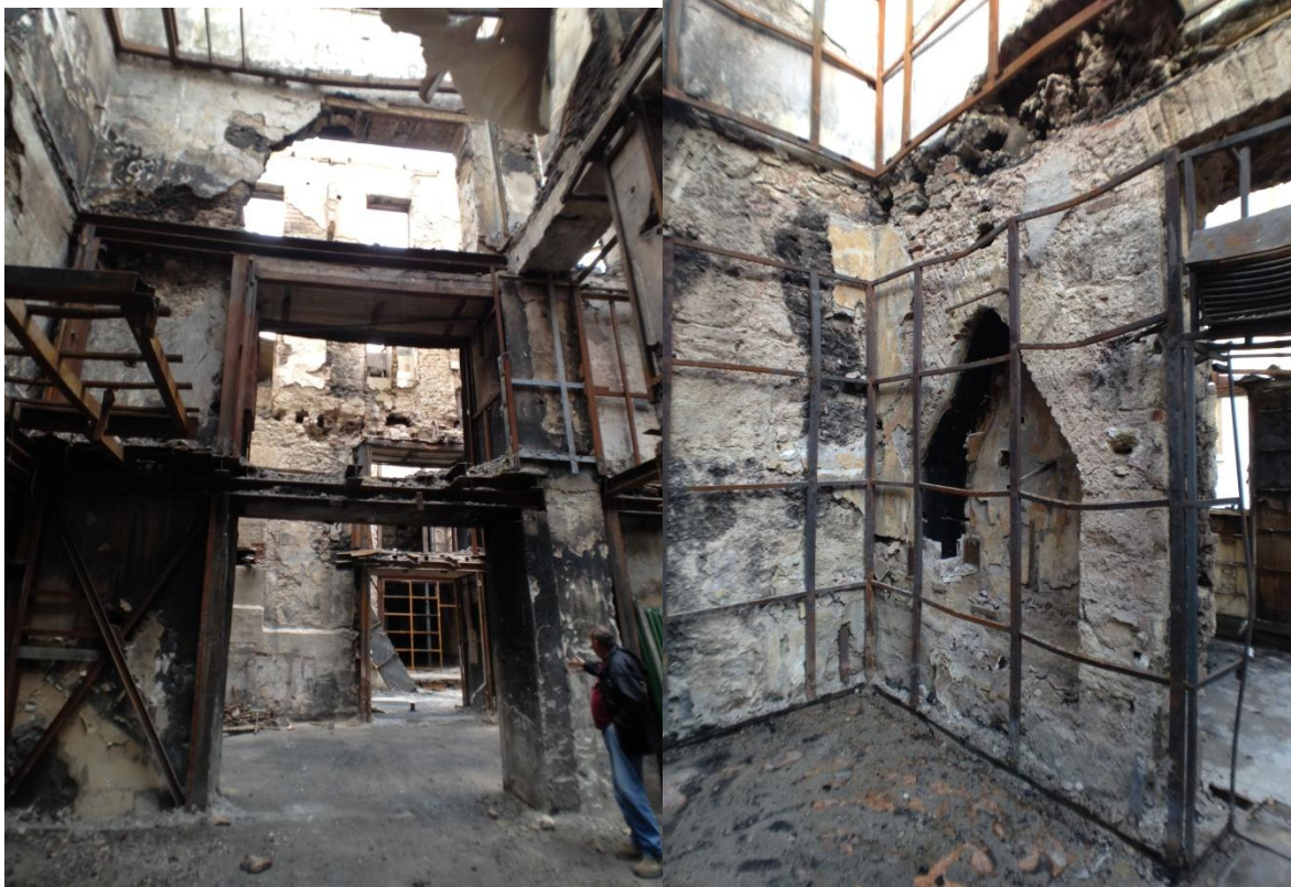
Εικόνα 36 - Άποψη σενάζ και μεταλλικών δοκών. Εικόνα 37 - Άποψη κατεστραμμένης σιδηροκατασκευής.
