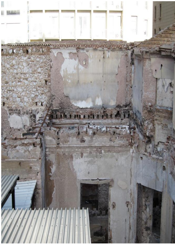
Εικόνα 57 - Τμήμα κατεστραμμένης τοιχοποιίας και στέγης.
