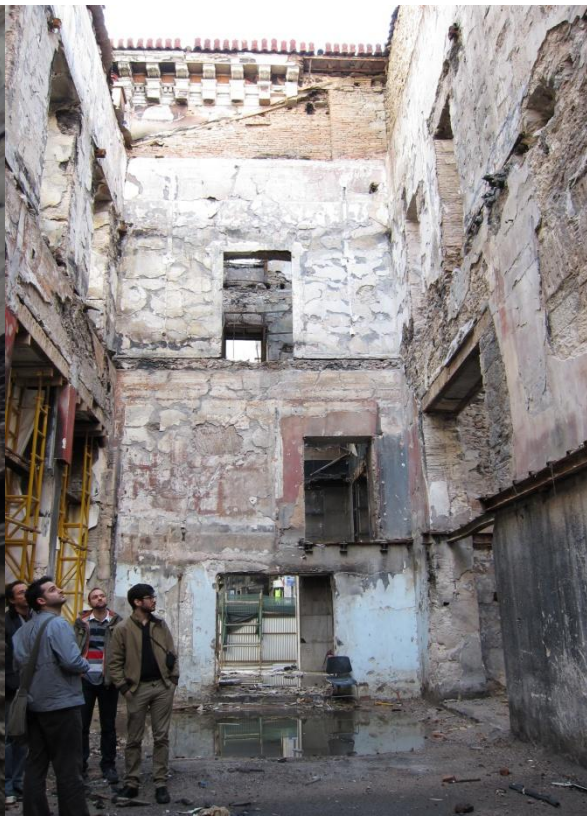
Εικόνα 43 - Άποψη φθορών καθ' ύψος όλης της τοιχοποιίας.
