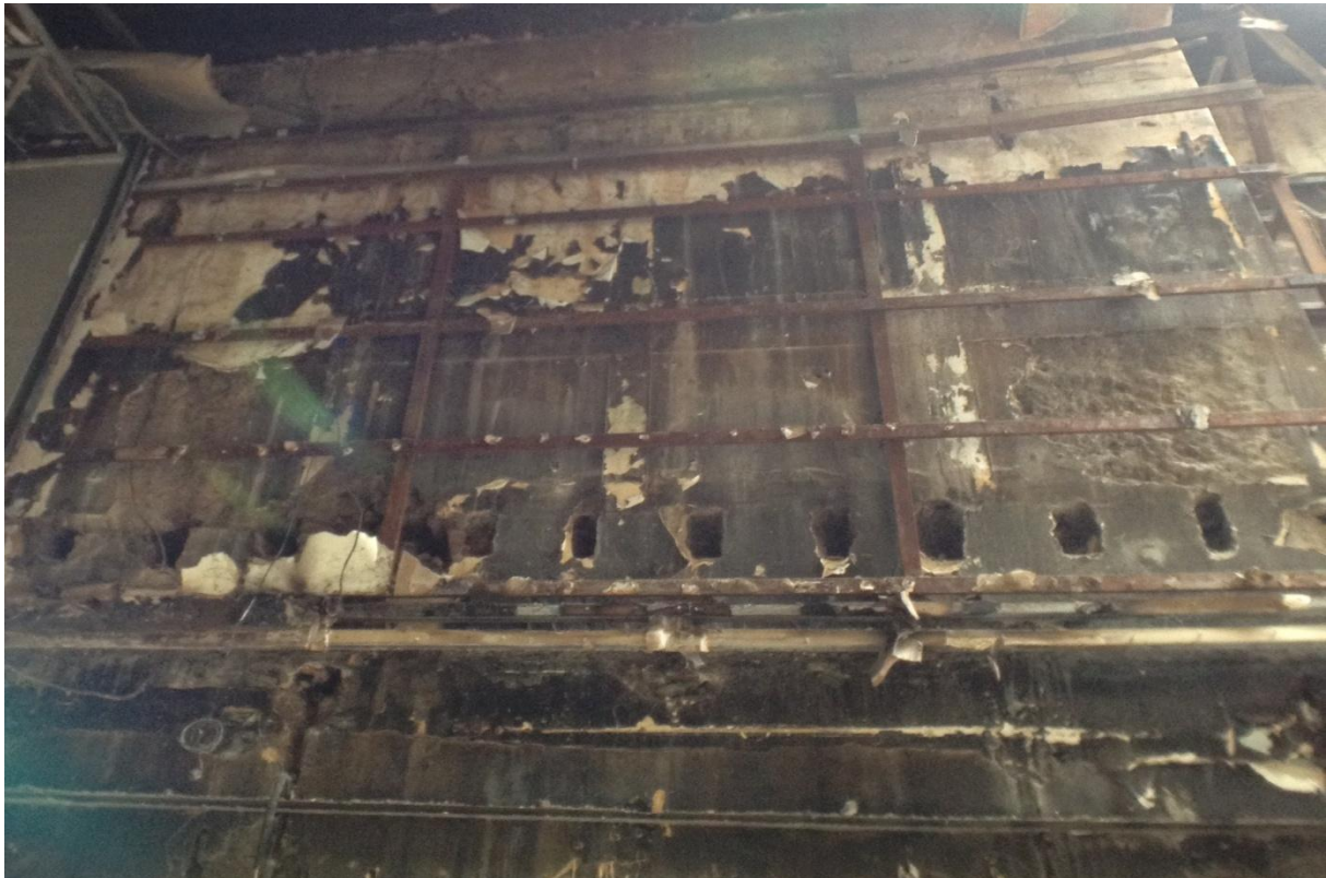
Εικόνα 23 - Άποψη κατεστραμμένης ελαφριού τύπου σιδηροκατασκευής – ένδειξη δοκοθηκών.
