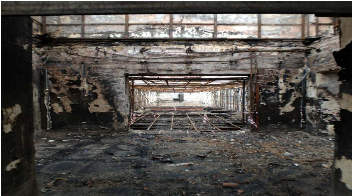
Εικόνα 24 A ,B - Κατεστραμμένο δάπεδο με οπλισμό και σκυρόδεμα.
