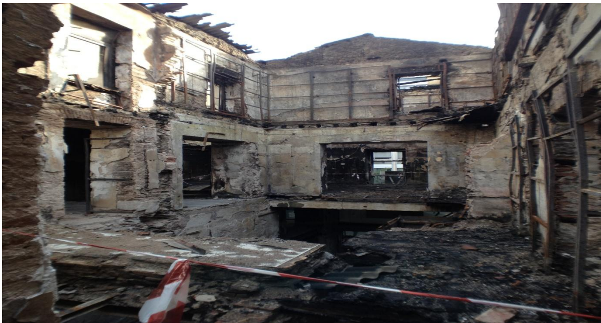
Εικόνα 24 - Άποψη φθορών τοιχοποιίας 2ου ορόφου
