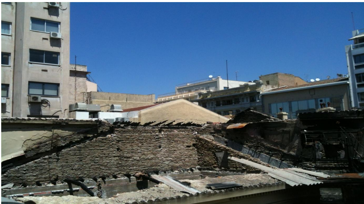
Εικόνα 27 - Ένδειξη υπολειμμάτων ξυλότυπου.
