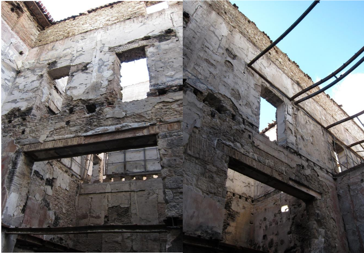
Εικόνα 44 - Εκτίναξη δομοστατικών υλικών. Εικόνα 45 - Φθορές περιμετρικά δοκοθηκών.
