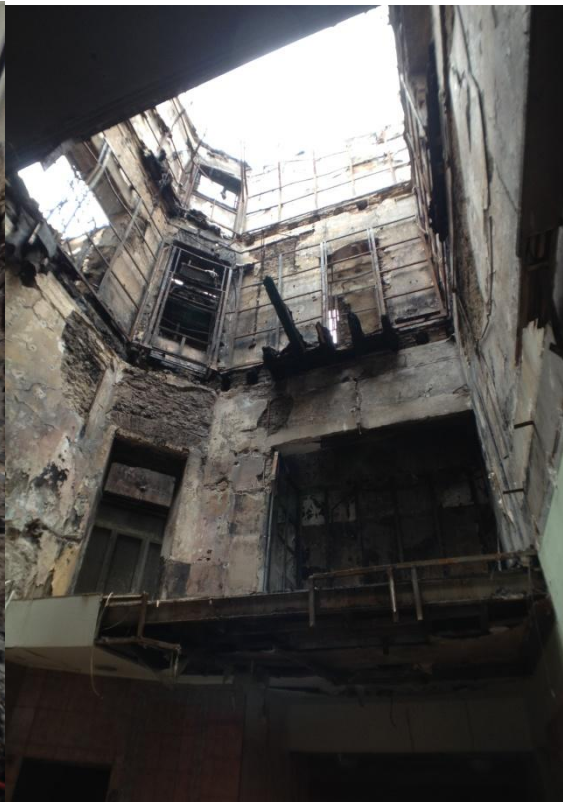
Εικόνα 41 - Άποψη κατεστραμμένων τοίχων και δαπέδων.
