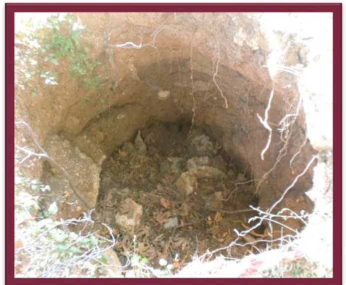
Εικόνα 30. Το χώμα έχει καλύψει τη λιθοδομή
