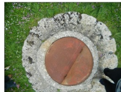
Βλάστηση/αξείδωση καλύμματος/βρύα/ρηγματώσεις στην λιθοδομή
