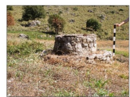
Αποκόλληση και ρηγιμάτωση επιχρίσματος/κενά στην λιθοδομή
