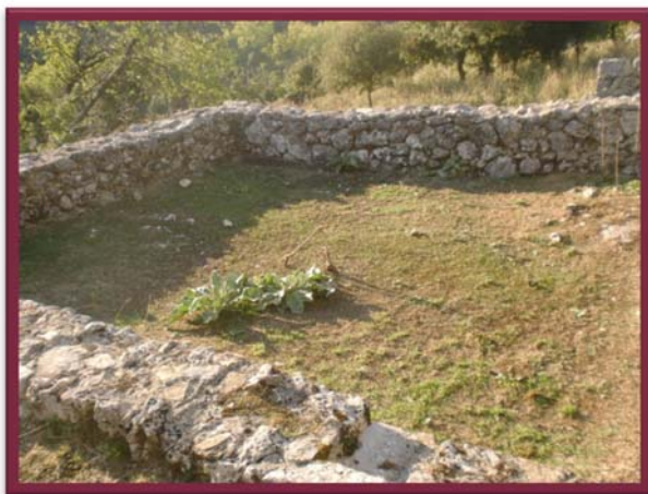
εικόνα 107. Το δώμα έχει κατακλυστεί από τη βλάστηση
