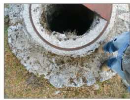
Ρωγμές στο επιχρίσμα/βλάστηση στο χείλος του αγωγίου
