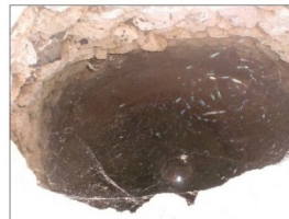
Εσωτερικά παρατηρείται διέγερση
