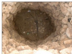
Εσωτερικά χωρίς νερό τον Σεπτέμβριο 2013
