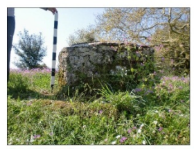
Έντονη βλάστηση/ ρηγματώση κονιάματος/ διεύρυνση αρμών/ καθίζηση
