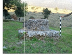
Αποκλιση επιχρίσματος/ρηγμάτωση τοιχοματιά/βλάστηση
