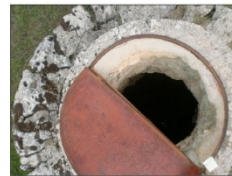
Έκτονη ρηγματώσεις (Σεπτέμβριος 2013)
