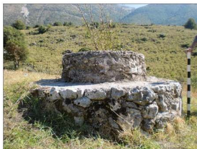
Διεύρυνση αρμών/ ρηγμάτωση κονιάς και αποκόλληση/ απουσία κονιάματος
