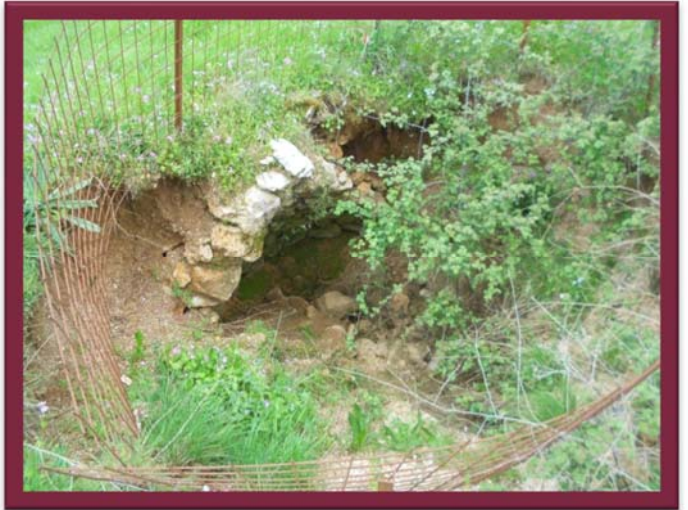
εικόνα 77. Το κατεστραμμένο πηγάδι βόρεια του 6ου.
