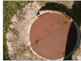
Ρηγματώσεις κονιάματος/αποκόλληση λίθων
