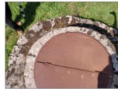
Ρηγματώσεις στο επιχρυσά
