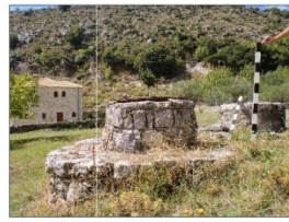
Ρηγματώση και αποκόλληση (τμηματική) του επιχρίσματος
