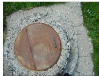
Πλάκα από μπετόν - Αποσαρβωση τσιμεντοκονίας/τριχοειδείς ρωγμές
