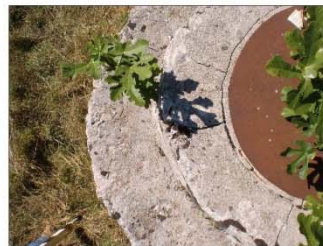
Ρηγμάτωση και αποκόλληση κονιάματος
