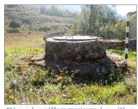
Βλάστηση/ αποκόλληση επιχρίματος/ αποκόλληση λίθων
