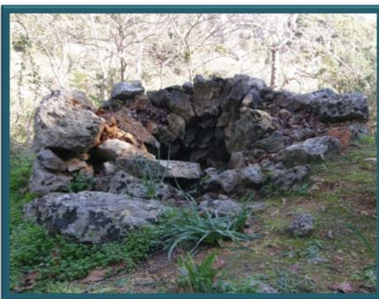
εικόνα 14. Κατεστραμμένο τμήμα πηγαδιού
