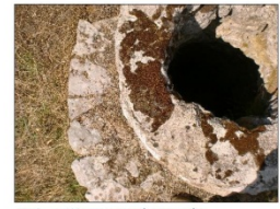
Κενά στην βάση και ρηγιμάτωση κονιάς
