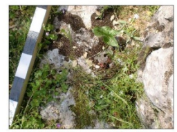
Θαμμένη βρύση/ βλάστηση/ αποκόλληση λίθων/ ρεγμάτωση τοιμενοκοινώματος
