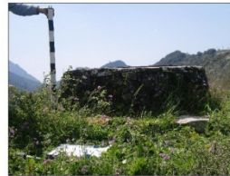
Διεύρυνση αρμών/ αποκόλληση λίθων/ ρηγματώση κονίας
