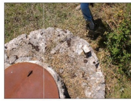
Ρωγμές στην λιθοδομή
