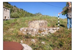
Έκτονος ρωγμές στην λιθοδομή και το επίχρυσμα ( 2)
