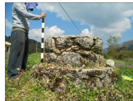
Ρηγματώση τοιχομακόνιατος και αποκόλληση/έλλειψη λίθων/διεύρυνση αρμών/βλάστηση
