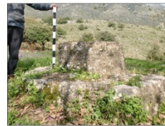
Ρηγματώσεις ταμπενονομιάματος, βλάστηση, αποδόληση
