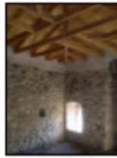
Εσωτερικό της οικίας. Τμήμα της διαρρηκτικής οροφής
