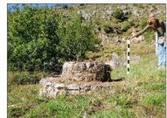
Έκτονος ρωγμές στην λιθοδομή και το επίχρυσμα ( 1)
