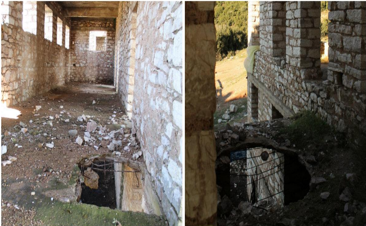
(Εικ. 22-23 Απεικονίσεις Οικοδομικών Προβλημάτων – Οπές στα δάπεδα 1ου & 2ου ορόφου)
