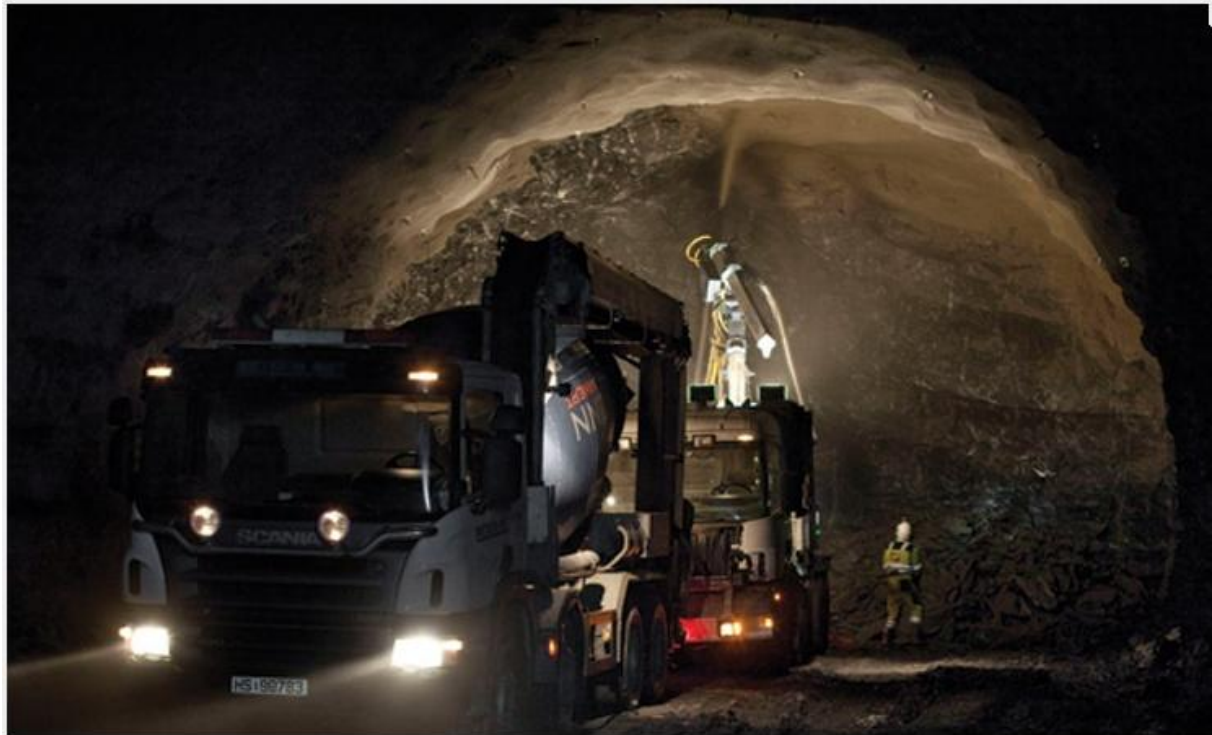
Εικόνα 10: Σύστημα ψεκασμού με κρυσταλλικά συστήματα
