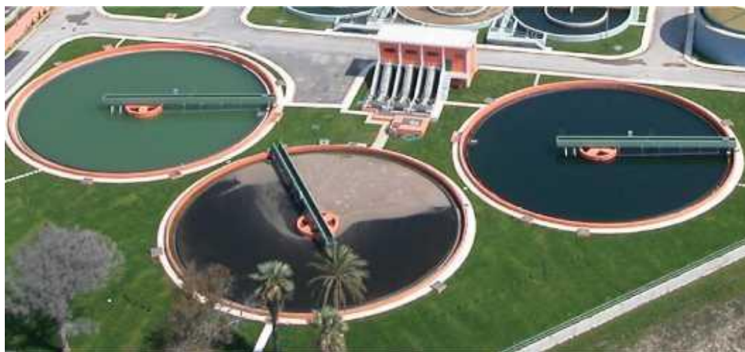
Εικόνα 38. Δεξαμενές τελικής καθίζησης
