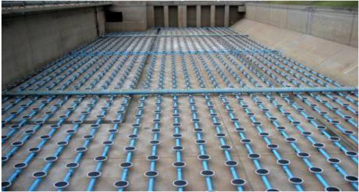
Εικόνα 31. Σύστημα αερισμού (β)
