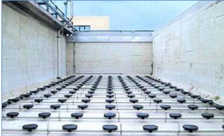
Εικόνα 11. Διαχυτές Αερισμού Λυμάτων Μεμβράνης
