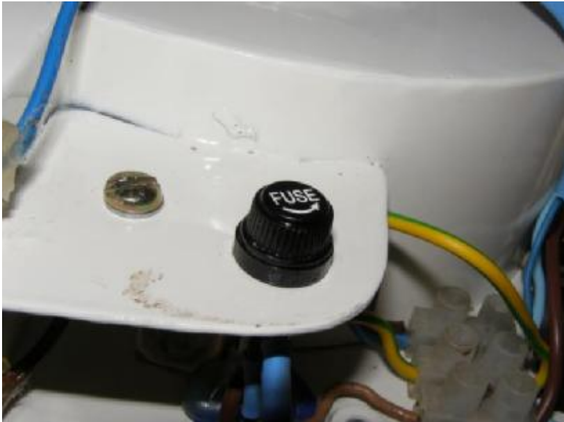
Εικόνα 22. Ηλεκτρική Ασφάλεια Προστασίας Πρόσοψη.
