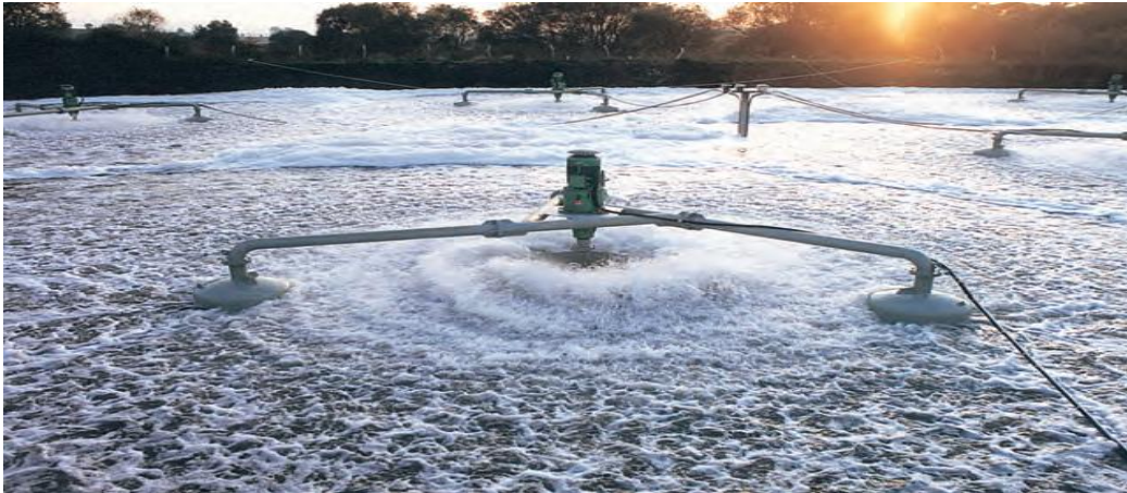
Εικόνα 2.35: Επιφανειακός αερισμός σε δεξαμενή επεξεργασίας λυμάτων ( www.marka-cevre.com )
