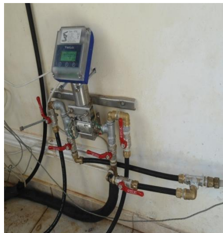
Εικόνα 1.31 : Σύστημα μέτρησης ροής στο ενδοδαπέδιο και στο σύστημα των συλλεκτών
