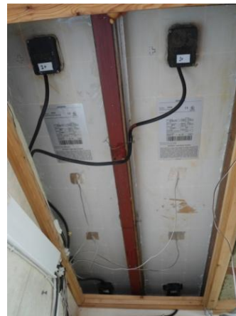
Εικόνα 7.7 : Πίσω όψη φωτοβολταϊκών πλαισίων από το εσωτερικό του οικίσκου
