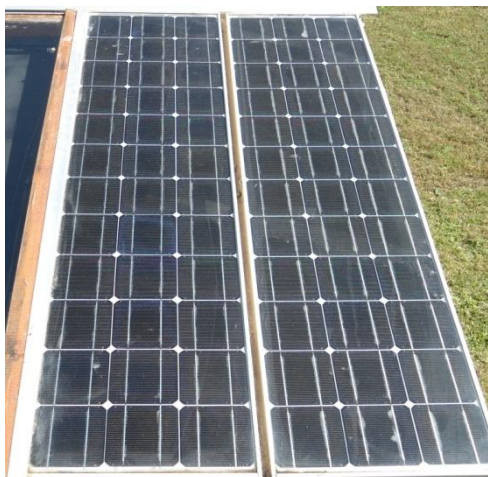
Εικόνα 1.20 : Φωτοβολταϊκά πλαίσια οικίσκου
