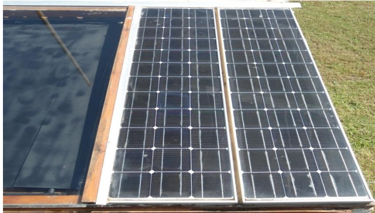
Εικόνα 7.1 : Εγκατεστημένα φωτοβολταϊκά πλαίσια στην στέγη του οικίσκου
