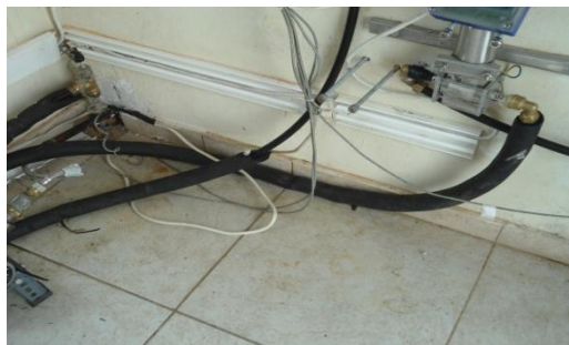
Εικόνα 1.8 : Σύνδεση ρομέτρου πριν την είσοδο για την ενδοδαπέδια θέρμανση
