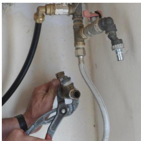
Εικόνα 1.30 : Αλλαγή σωληνώσεων στην σύνδεση των συλλεκτών
