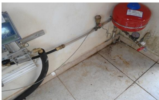
Εικόνα 1.9: Είσοδος ενδοδαπέδιας και δοχείο διαστολής
