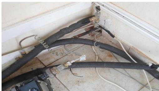
Εικόνα 1.7 : Έξοδος νερού ενδοδαπέδιας – Είσοδος συλλεκτών
