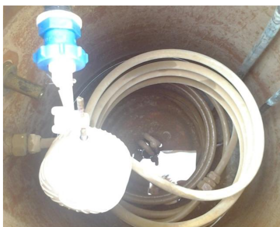
Εικόνα 5.3 : Άδειασμα δεξαμενής αποθήκευσης ζεστού νερού του οικίσκου κατά την πειραματική διαδικασία
