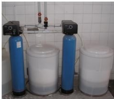
Δίδυμο σύστημα αποσκλήρυνσης οικιακής εγκατάστασης
