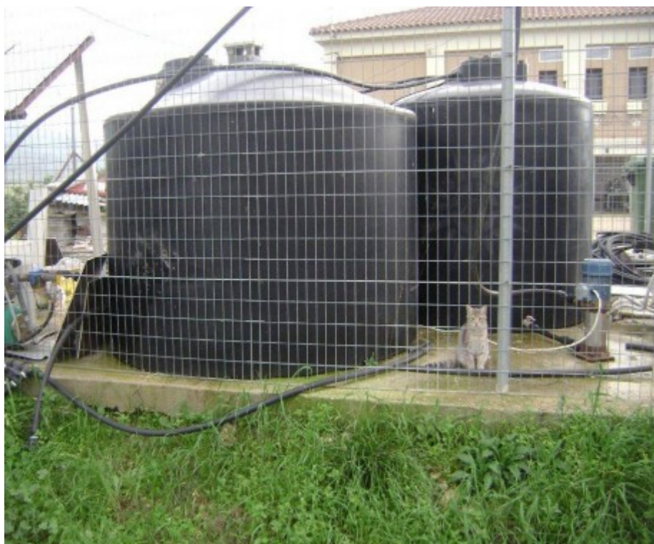
Εικόνα 24: Οι δύο δεξαμενές της εγκατάστασης.
