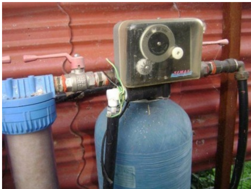
Εικόνα 25: Αποσκληρυντής μιας στήλης (μονός), της εγκατάστασης.
