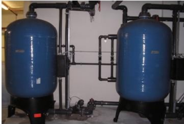
Δίδυμο σύστημα αποσκλήρυνσης βιομηχανικής εγκατάστασης
