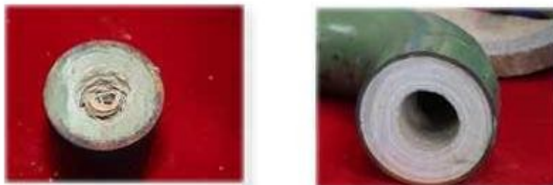
Εικόνα 13: Επικαθίσεις αλάτων σε σωληνώσεις [8,9]
