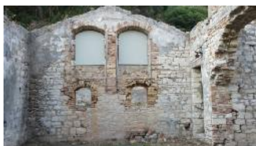
Αποδιοργάνωση, κατάρρευση οπτόπλινθου
