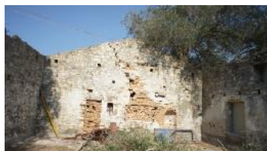
Μεταγενέστερες επεμβάσεις, δείγμα ρωγμής μεγάλου εύρους
