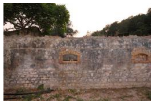
Δείγμα αποσάθρωσης επιχρίσματος
