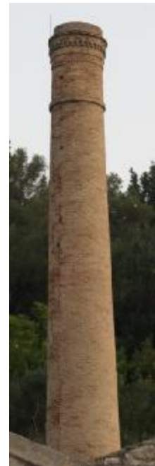
Δείγμα ρωγμής καμινάδας
