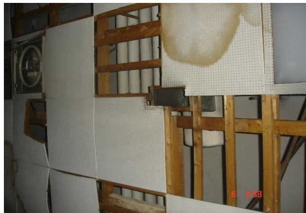
Εικόνα 37: Κατεστραμμένο τμήμα ψευδοροφών
