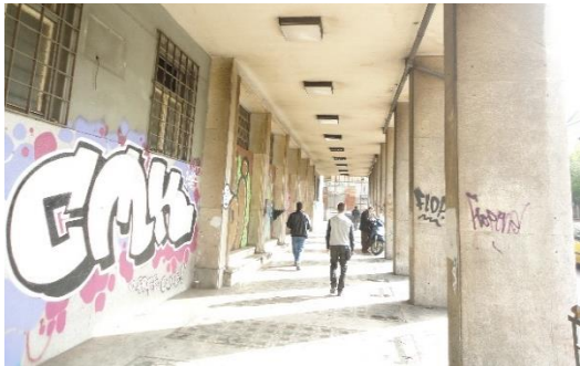
Εικόνα 35: graffiti στα υποστυλώματα και στις τοιχοποιίες του ισονείου
