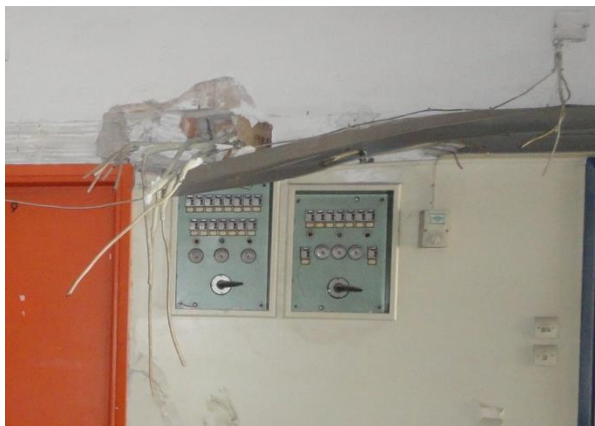
Εικόνα 29: Παλιοί ηλεκτρικοί πίνακες
