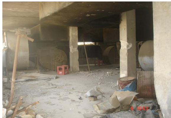
Εικόνα 14: Εσωτερικό μηχανοστασίου δώματος
