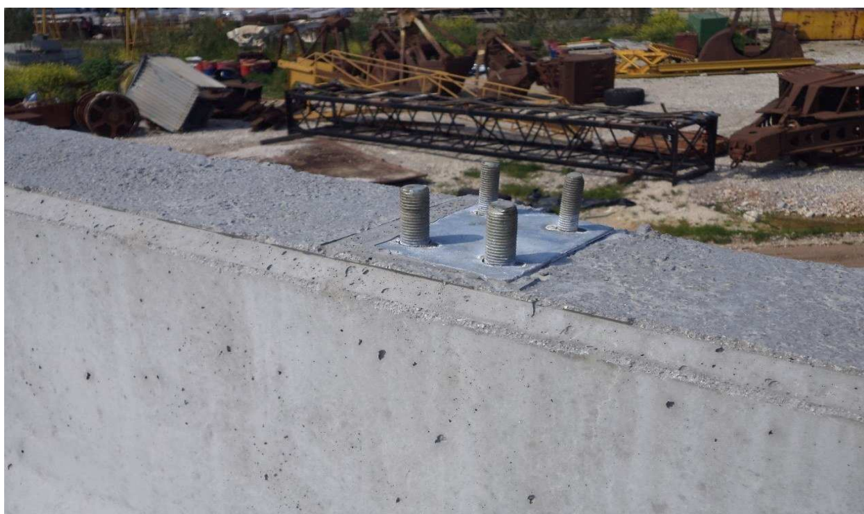
Φωτ. 6.13 Στηθαίο ασφαλείας από σκυρόδεμα με πακτωμένη βάση στερέωσης στύλου ηλεκτροφωτισμού, όπου φαίνονται τα βλήτρα.
