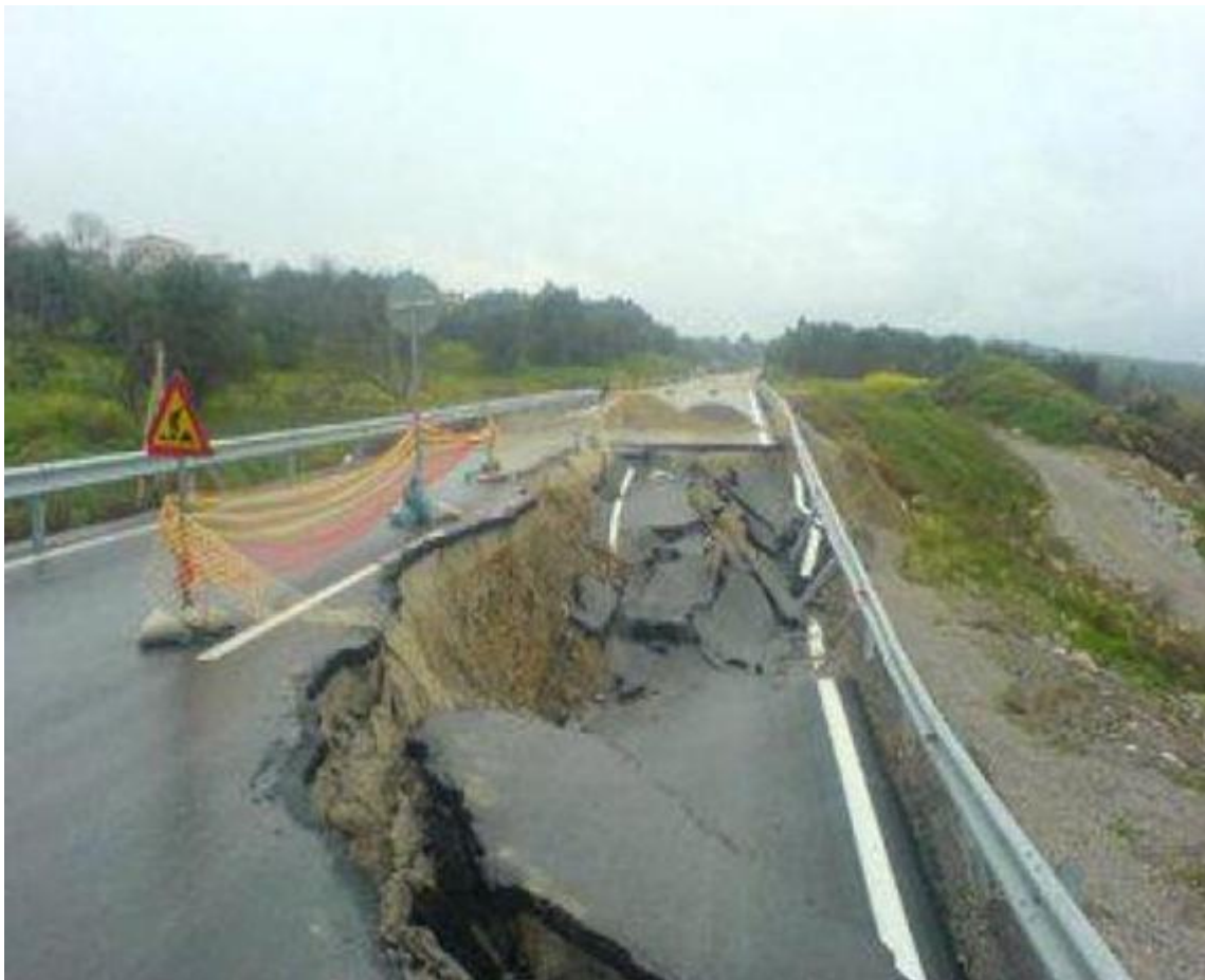
Εικόνα 5.7 Καθίζηση στην εθνική οδό Πρέβεζας – Ηγουμενίτσας
