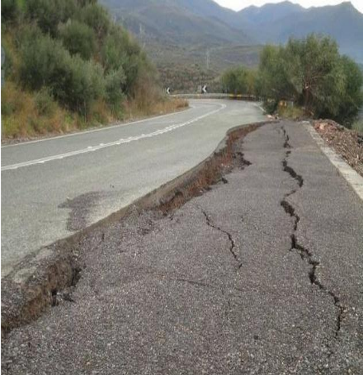
Εικόνα 5.8 Καθίζηση σε δρόμο στη Τσακώνα
