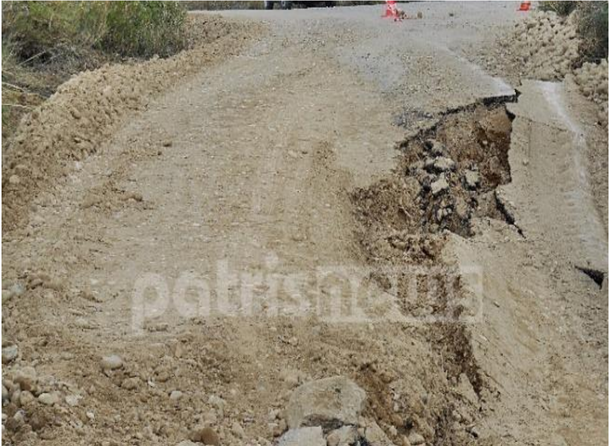
Εικόνα 5.10 Καθίζηση στην επαρχιακή οδό Πύργου – Οινόης
