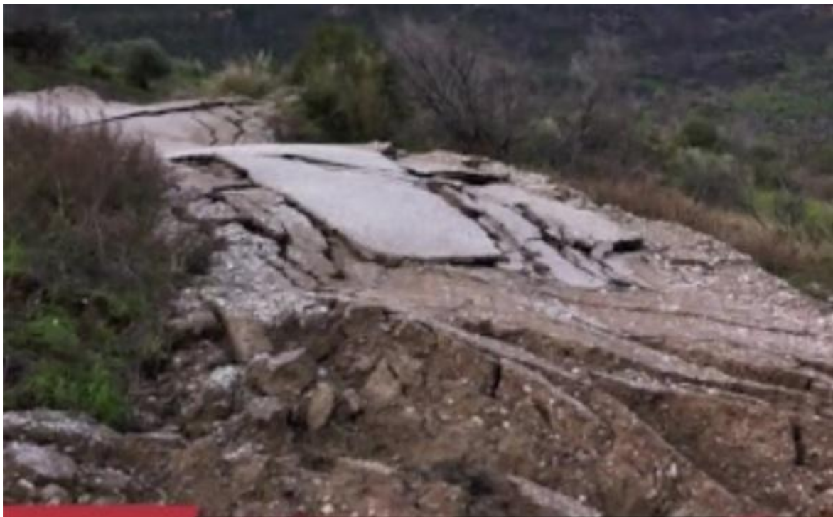
Εικόνα 5.4 Καθίζηση στη περιοχή της Ζαχάρως
