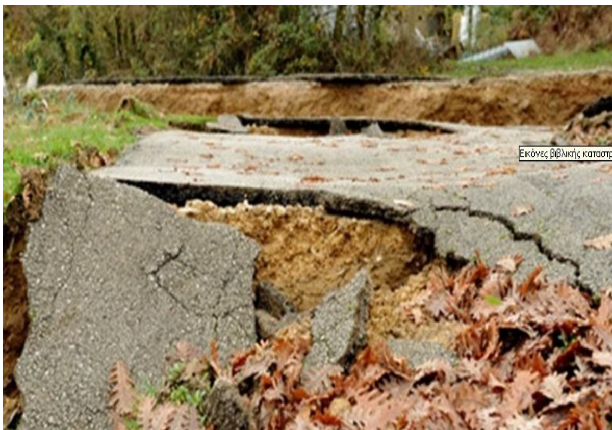
Εικόνα 5.3 Καθίζηση δρόμου στους Μουζακέους Ιωαννίνων
