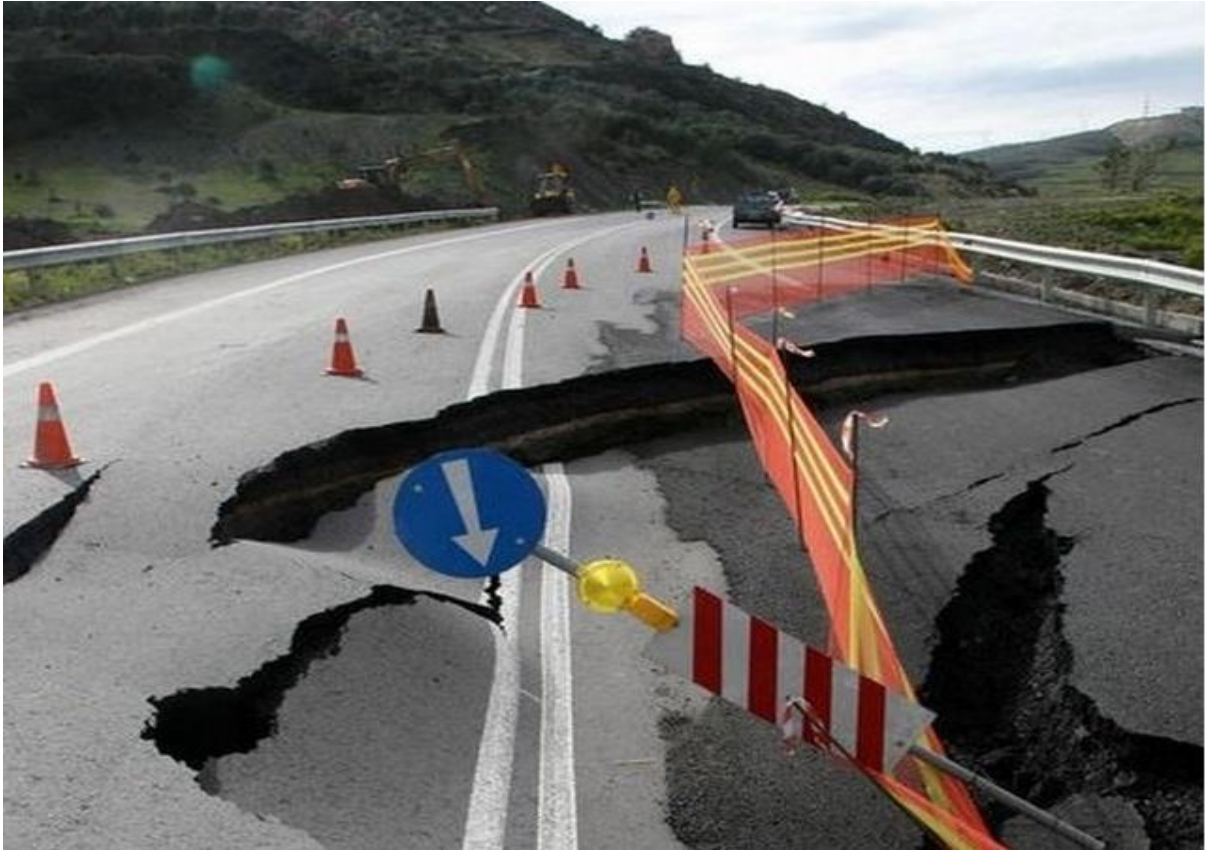
Εικόνα 5.9 Καθίζηση στο δρόμο Μεγαλόπολης – Ακόβου
