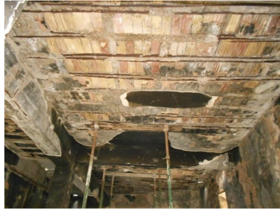
Εικ.38: Προχωρημένη ενανθράκωση οπλισμού που οδήγησε στην αποκόλληση του επιχρίσματος.
