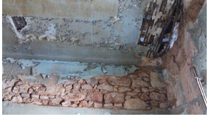
Εικ.34: Τοπική αποκόλληση επιχρίσματος.
