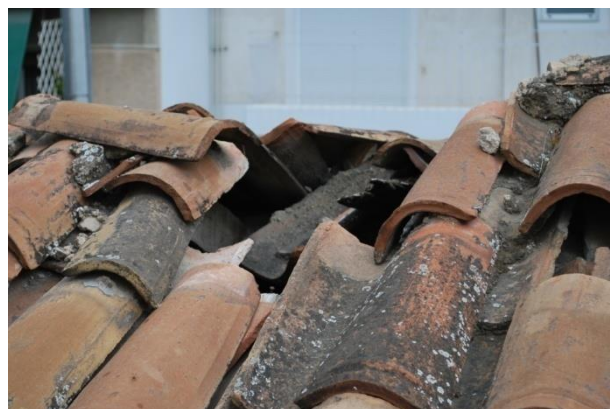
Εικ.36: Τοπική κατάρρευση της στέγης λόγω σήψης του σκελετού της στέγης.
