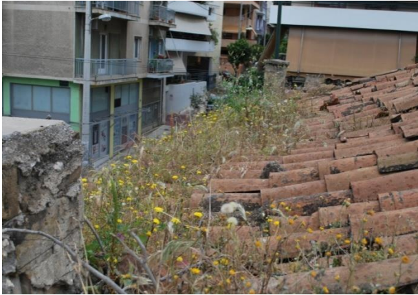
Εικ.37: Ανάπτυξη ζιζανίων περιμετρικά της στέγης.
