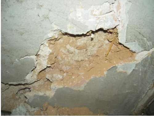
Εικ.33: Αποσάρθρωση κονιάματος αρμολόγησης
