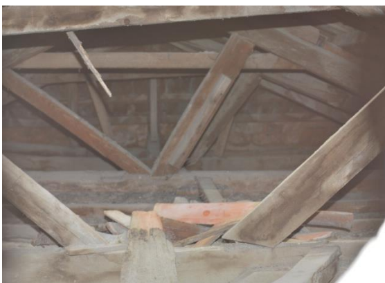
Εικ.35: Φθορές στον ξύλινο σκελετό της στέγης.
