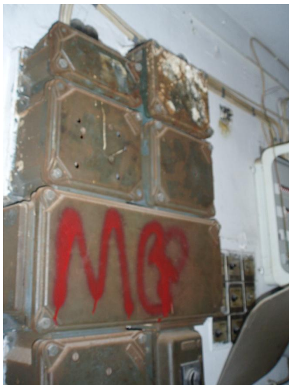
Εικόνα 26 Παλιός ηλεκτρικός πίνακας
