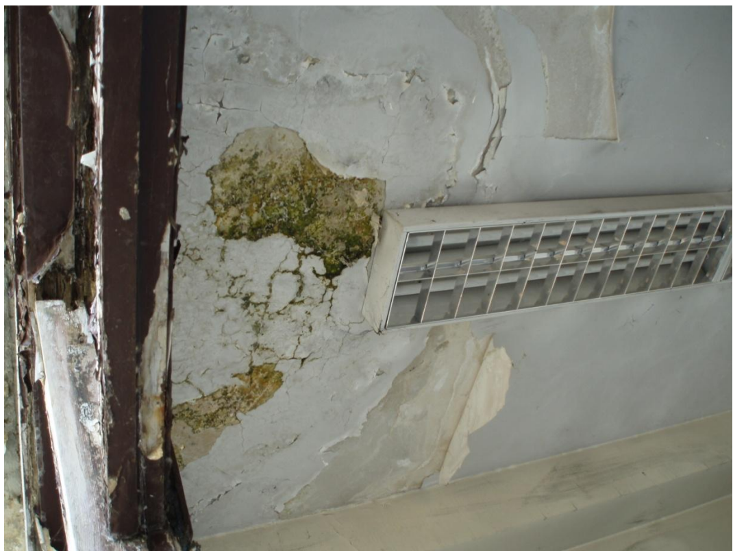
Εικόνα 59 Υγρασία στο ταβάνι της αίθουσας 1 λόγω κατεστραμένου κουφώματος
