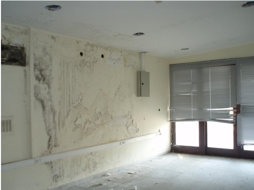
Εικόνα 62 Γυψοσανίδα με υγρασία λόγω κατεστραμμένων κουφωμάτων
