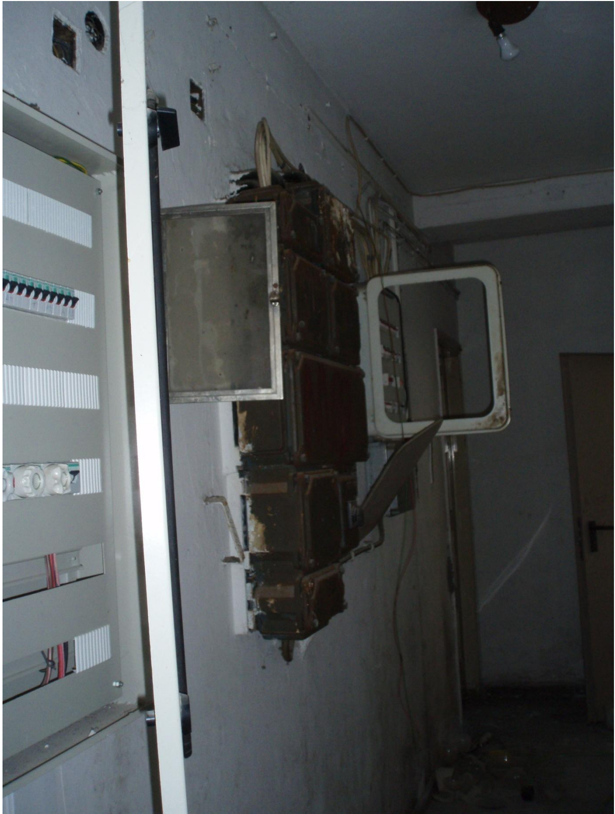
Εικόνα 27 Παλιός ηλεκτρικός πίνακας σε αντιδιαστολή με τον νέο
