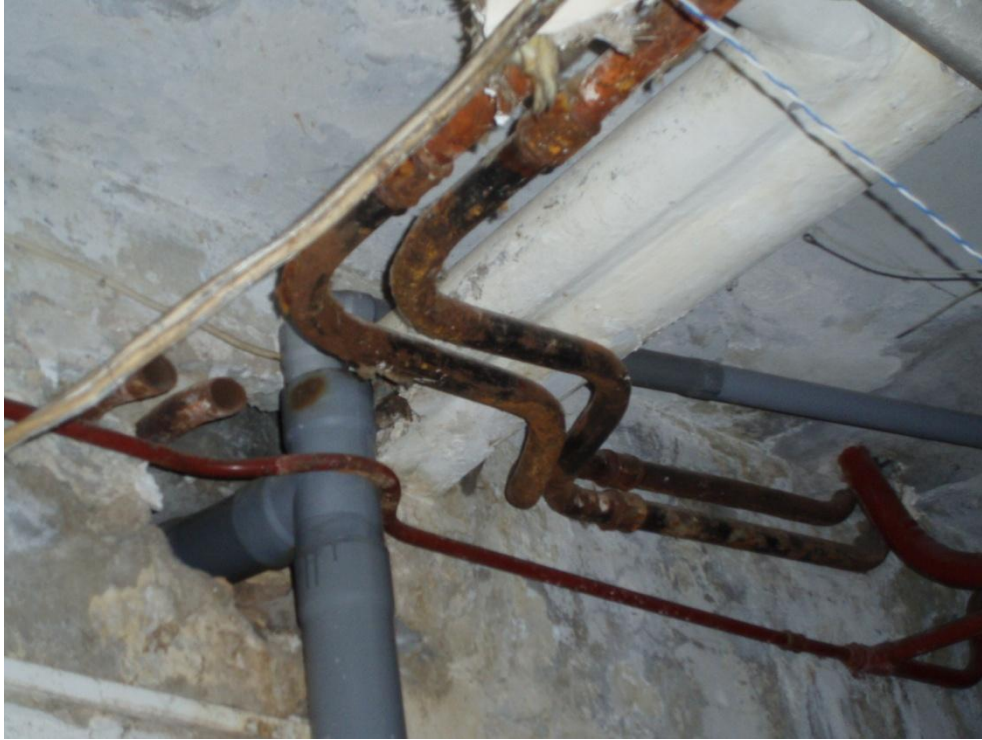
Εικόνα 50 Παλιές και νέες σωληνώσεις
