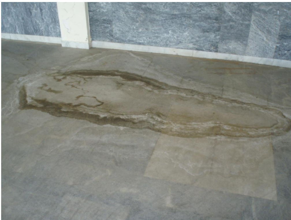
Εικόνα 23 Κομμάτι μαρμάρινου δαπέδου με αποτύπωμα υγρασίας στην είσοδο του κτηρίου
