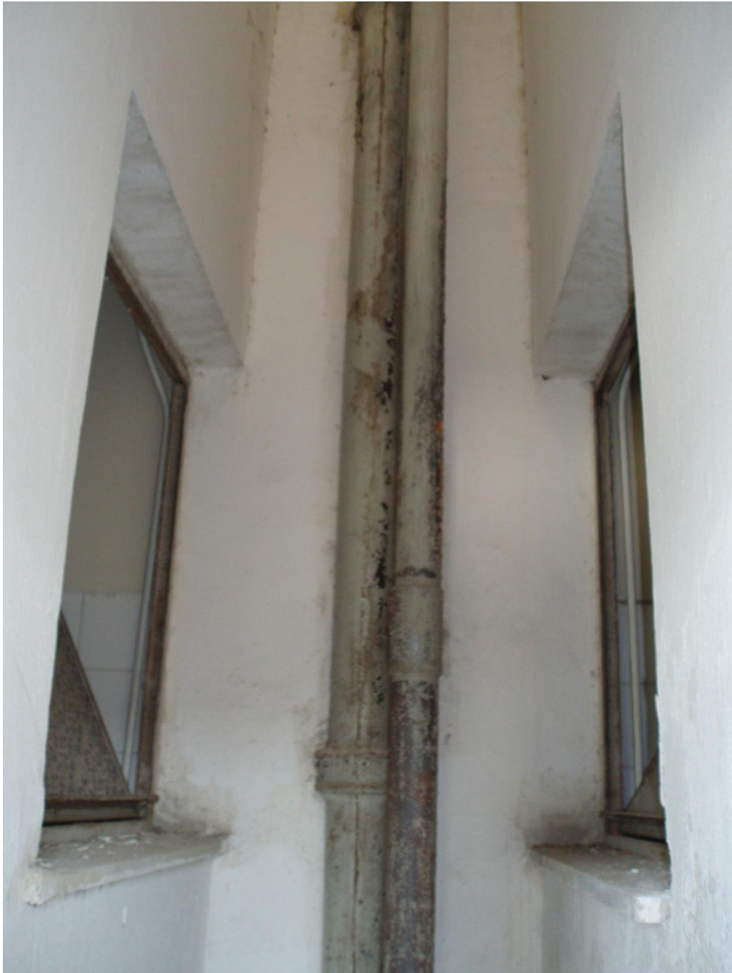
Εικόνα 80 Χώρος εξαερισμού των λουτρών των δωματίων
