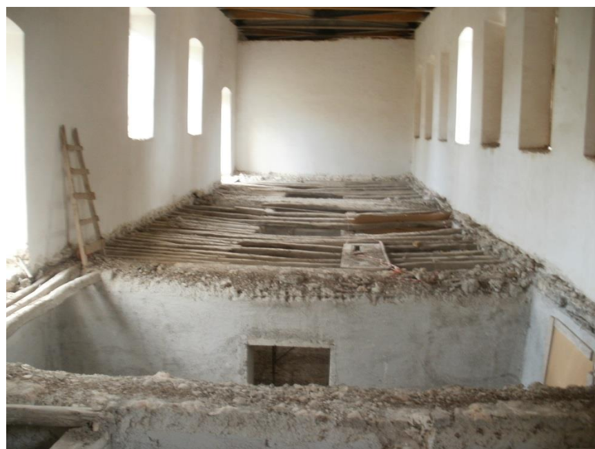
Εικόνα 119 Αδιαμόρφωτος χώρος υπογείου. Έχει αφαιρεθεί το ξύλινο πάτωμα και δεν έχει κατασκευαστεί πλάκα από Ο.Σ. όπως στο υπόλοιπο κτήριο
