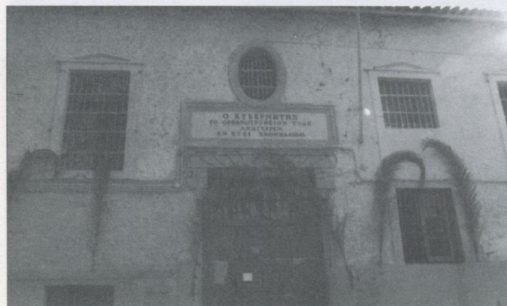
Η κεντρική πύλη του Όρφανοτροφείου με τήν κτητορική έπιγραφή. Έπάνω από τήν έπιγραφή τò χαρακτηριστικό ceil de base , παράθυρο που ένισχύει τò φωτισμό τής είσοδου.
