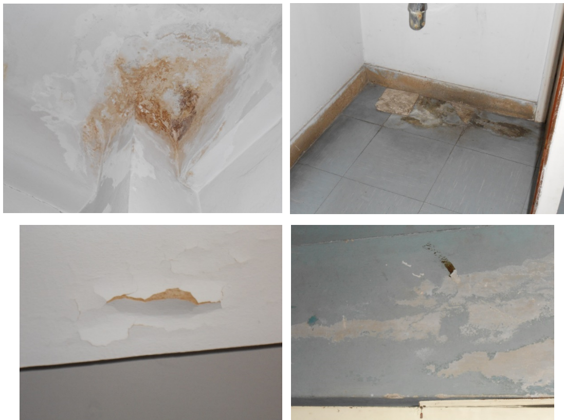
Εικόνα 69, 70, 71, 72: Βλάβες εσωτερικά του κτιρίου
