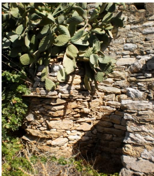
Εικ. 153. : Κατάρρευση τμήματος που οδηγεί στο λιακό 1. Πηγή : Προσωπικό
