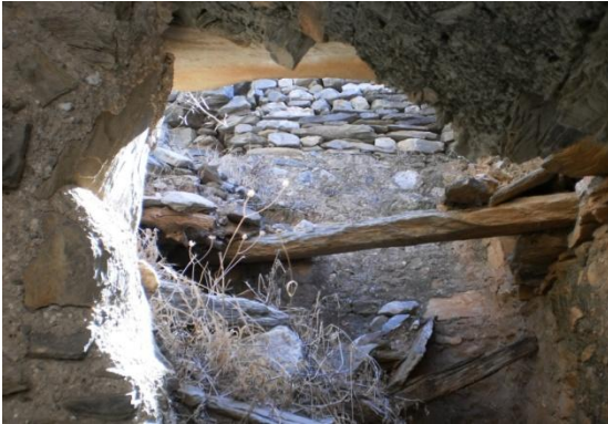
Εικ. 141. : Κατάρρευση οροφής στο ανώι του φουρνόσπιτου. Πηγή : Προσωπικό αρχείο.
