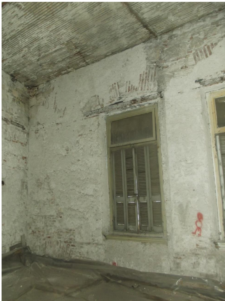
Εικόνα 42. Αντίστοιχη υγρασία στο εσωτερικό του κτιρίου
