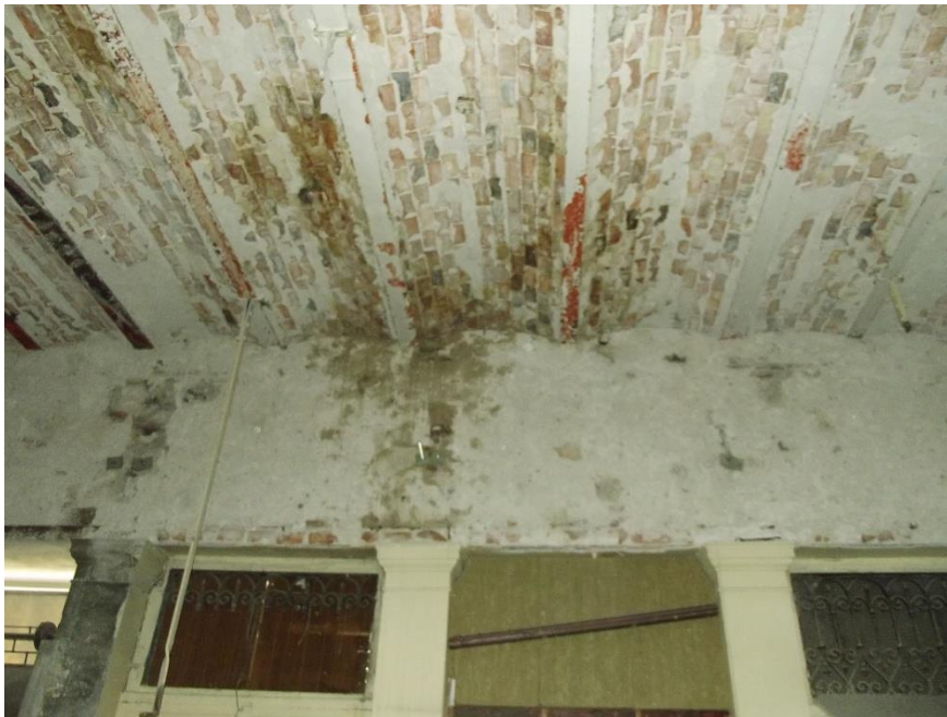
Εικόνα 37. Υγρασία στην φέρουσα τοιχοποιία
