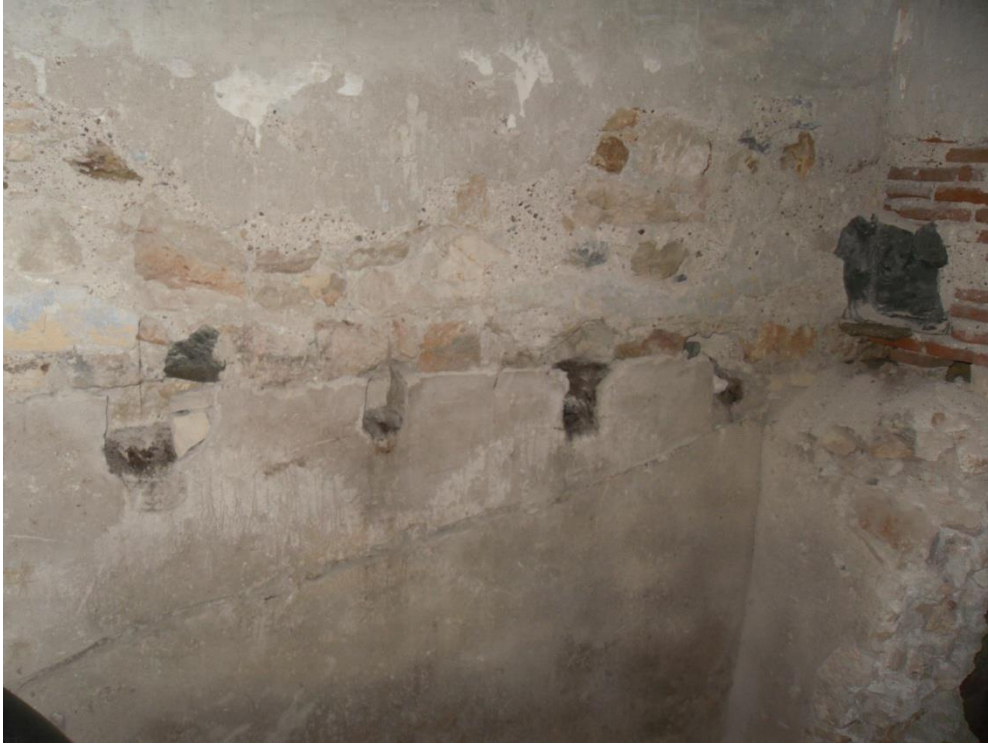
Εικόνα 40. Ρηγμάτωση και δοκοθήκες στον [ΧΠ1]
