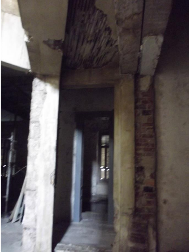
Εικόνα 7. Ένδειξη ύπαρξης ανοίγματος
