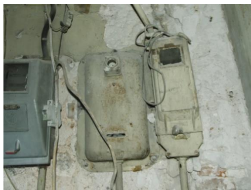
Εικόνα 51. Ηλεκτρολογικές εγκαταστάσεις εισόδου
