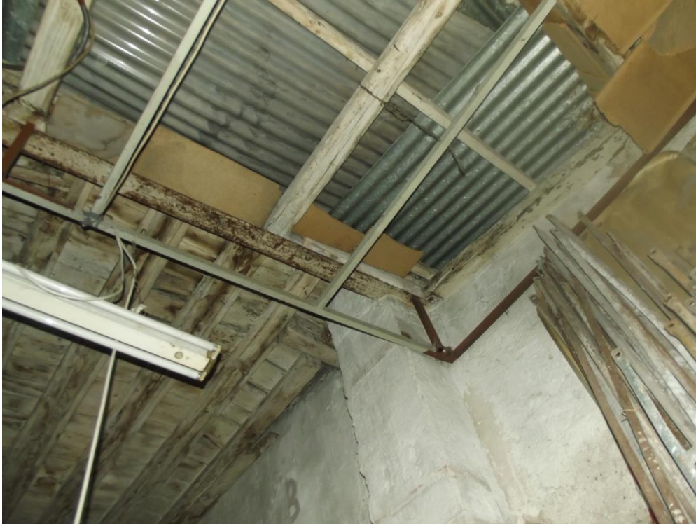
Εικόνα 11. Υπόλειμα ξύλινης κατασκευής στεγάστρου
