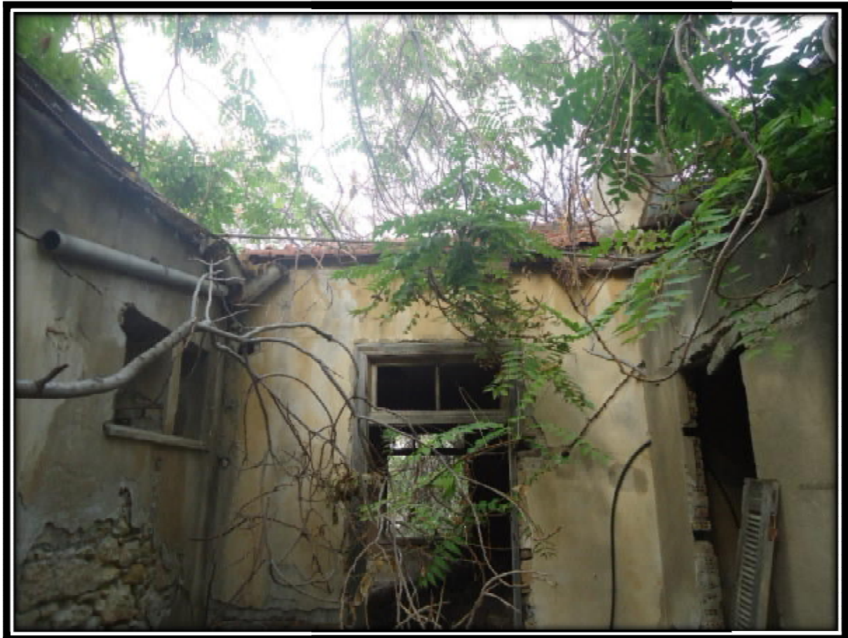
ΦΩΤΟΓΡΑΦΙΑ 5-19 ΚΑΤΑΡΕΥΣΗ ΤΗΣ ΛΙΘΟΠΟΙΑΣ ΚΑΙ ΤΟΥ ΕΠΙΧΡΙΣΜΑΤΟΣ
