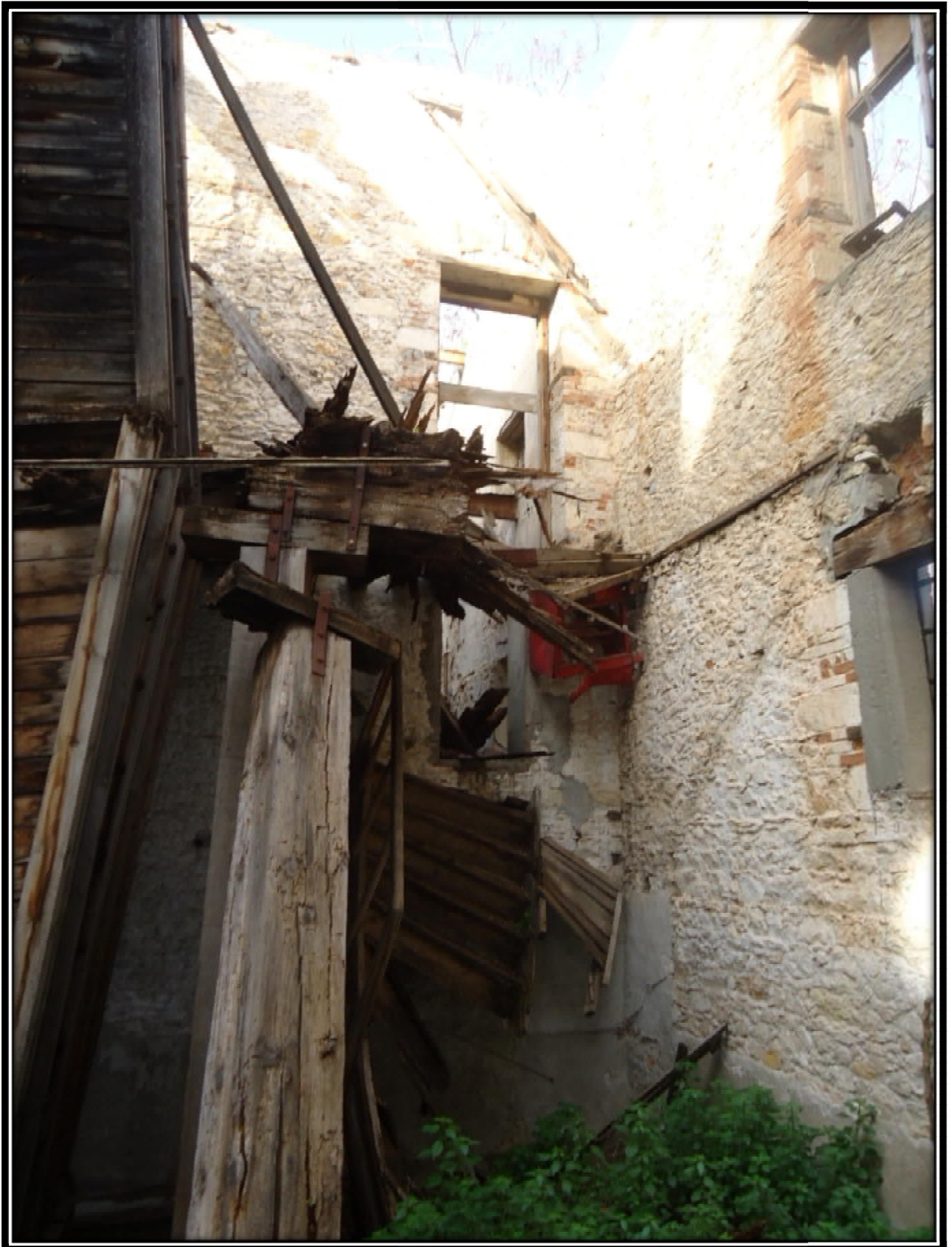
ΦΩΤΟΓΡΑΦΙΑ 3-3 ΦΘΟΡΕΣ ΑΠΟ ΤΗΝ ΚΑΤΑΡΕΥΣΗ ΤΗΣ ΣΤΕΓΗΣ
