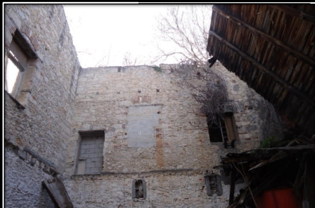
ΦΩΤΟΓΡΑΦΙΑ 2-1 ΚΑΤΑΡΕΥΣΗ ΤΗΣ ΣΤΕΓΗΣ ΚΑΙ ΤΗΣ ΠΛΑΚΑΣ ΤΟΥ ΟΡΟΦΟΥ
