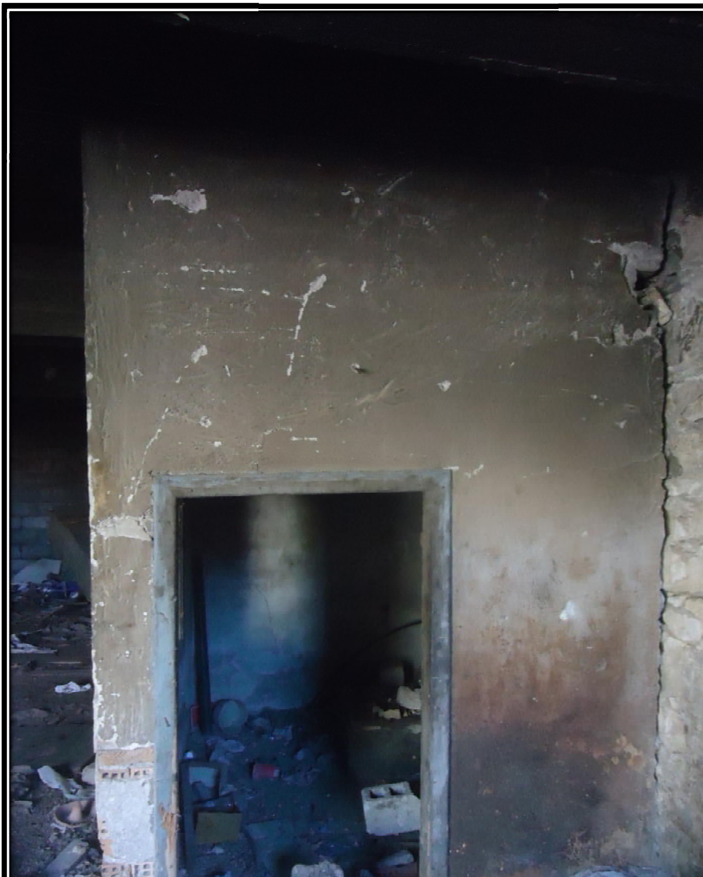
ΦΩΤΟΓΡΑΦΙΑ 6-1 ΦΘΟΡΕΣ ΣΤΟ ΕΠΙΧΡΙΣΜΑ ΤΗΣ ΤΟΙΧΟΠΟΙΑΣ ΤΟΥ ΔΩΜΑΤΙΟΥ
