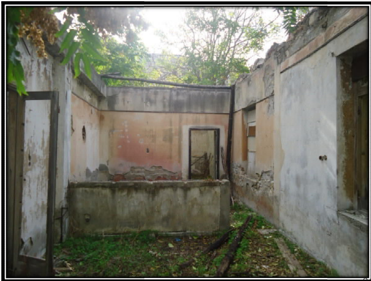
ΦΩΤΟΓΡΑΦΙΑ 5-9 ΦΩΤΟΓΡΑΦΙΑ 53 ΦΘΟΡΑ ΣΤΟ ΗΜΙΤΕΙΧΙΟ ΛΟΓΩ ΤΗΣ ΕΜΦΑΝΙΣΗΣ ΜΙΚΡΟΟΡΓΑΝΙΣΜΩΝ ΑΠΟ ΤΗΝ ΥΓΡΑΣΙΑ
