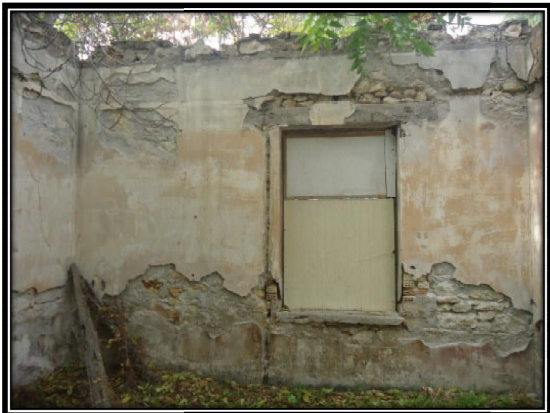
ΦΩΤΟΓΡΑΦΙΑ 5-3 ΦΩΤΟΓΡΑΦΙΑ48 ΚΑΤΑΡΕΥΣΗ ΣΤΕΓΗΣ
