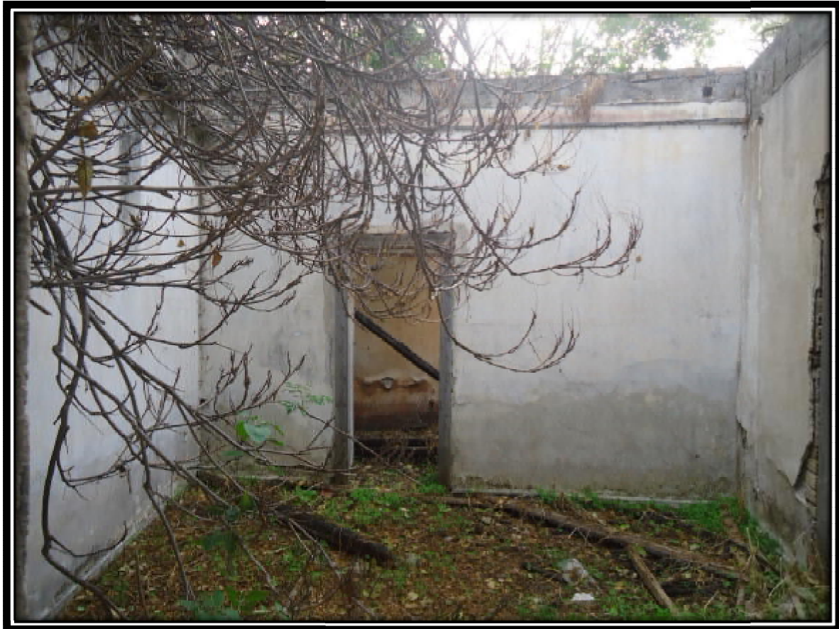
ΦΩΤΟΓΡΑΦΙΑ 5-8 ΚΑΤΑΡΕΥΣΗ ΤΟΥ ΣΚΥΡΟΔΕΜΑΤΟΣ ΤΗΣ ΣΤΕΓΗΣ
