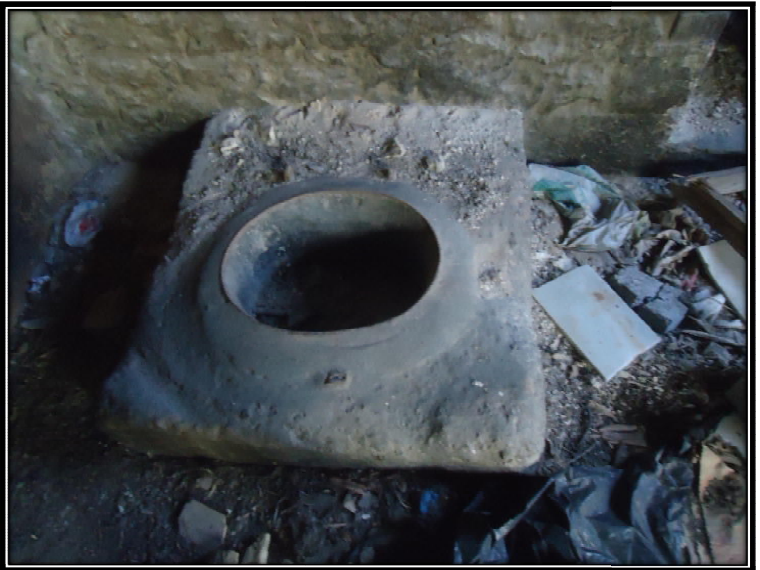
ΦΩΤΟΓΡΑΦΙΑ 7-4 ΑΠΟΚΟΛΛΗΣΗ ΤΟΥ ΕΠΙΧΡΙΣΜΑΤΟΣ ΚΑΙ ΤΡΙΧΩΕΙΔΗΣ ΡΩΓΜΕΣ ΠΕΡΙΜΕΤΡΙΚΑ ΤΟΥ ΑΝΟΙΓΜΑΤΟΣ
