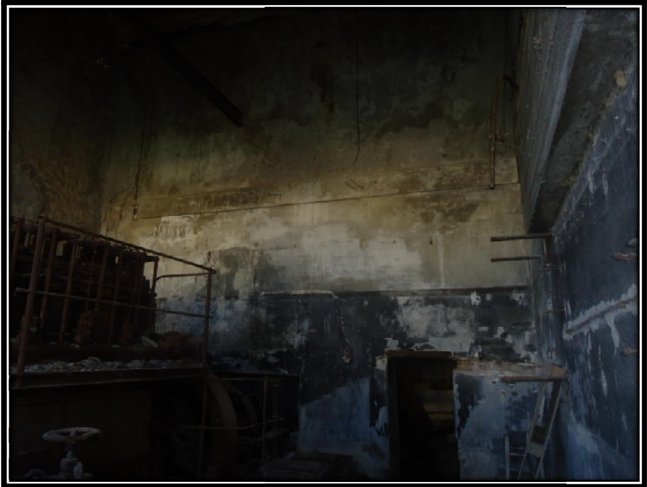
ΦΩΤΟΓΡΑΦΙΑ 3-5 ΦΘΟΡΕΣ ΣΤΟ ΣΚΥΡΟΔΕΜΑ ΚΑΙ ΤΗΝ ΤΟΙΧΟΠΟΙΑ
