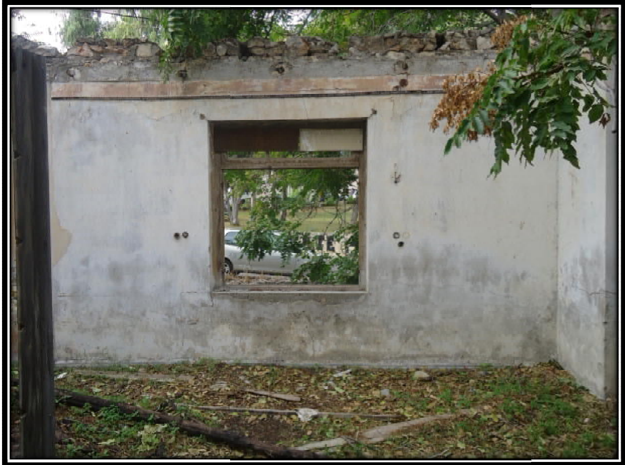
ΦΩΤΟΓΡΑΦΙΑ 5-7 ΔΙΑΒΡΩΣΗ ΤΟΥ ΧΡΩΜΑΤΙΣΜΟΥ ΠΕΡΙΜΕΤΡΙΚΑ ΤΟΥ ΑΝΟΙΓΜΑΤΟΣ
