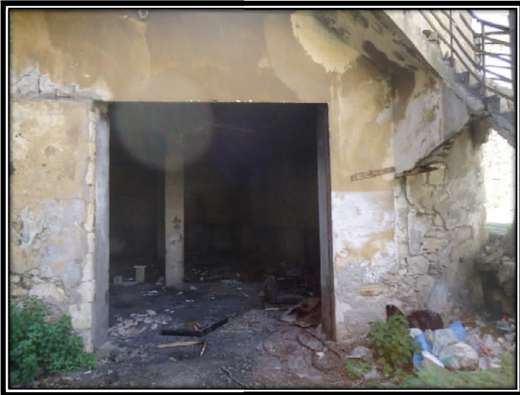
ΦΩΤΟΓΡΑΦΙΑ 4-1 ΑΠΟΣΑΡΘΡΩΣΗ ΤΟΥ ΕΠΙΧΡΙΣΜΑΤΟΣ ΤΗΣ ΛΙΘΟΠΟΙΑΣ
