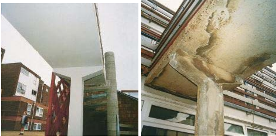
Εικόνα 2.1 Γέφυρα πεζών στο δεύτερο όροφο νοσοκομείου, πριν και μετά από τη διάβρωσή της, λόγω χλωριόντων από εκχιονιστικά άλατα. [4]
