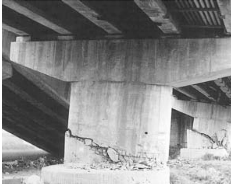
Εικόνα 1.6 Αστοχία καμπτικού τύπου [3].
