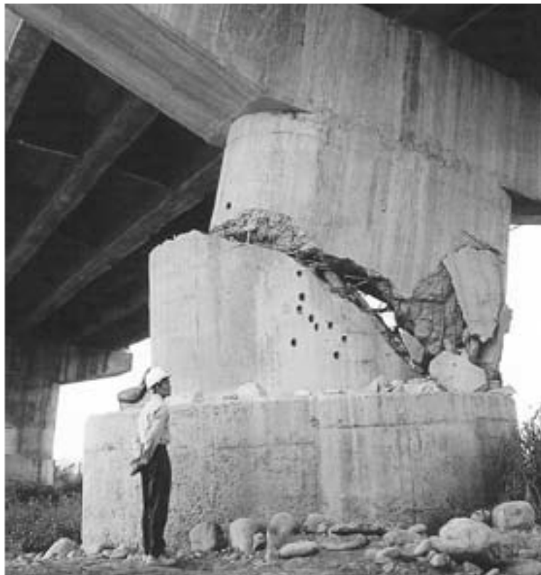
Εικόνα 1.7 Αστοχία διατμητικού τύπου [3].
