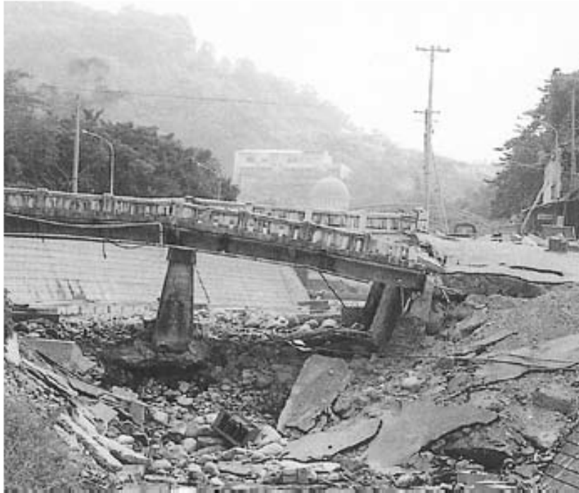
Εικόνα 1.8 Αστοχία ακρόβαθρου λόγω ρευστοποίησης εδάφους θεμελίωσης [3].
