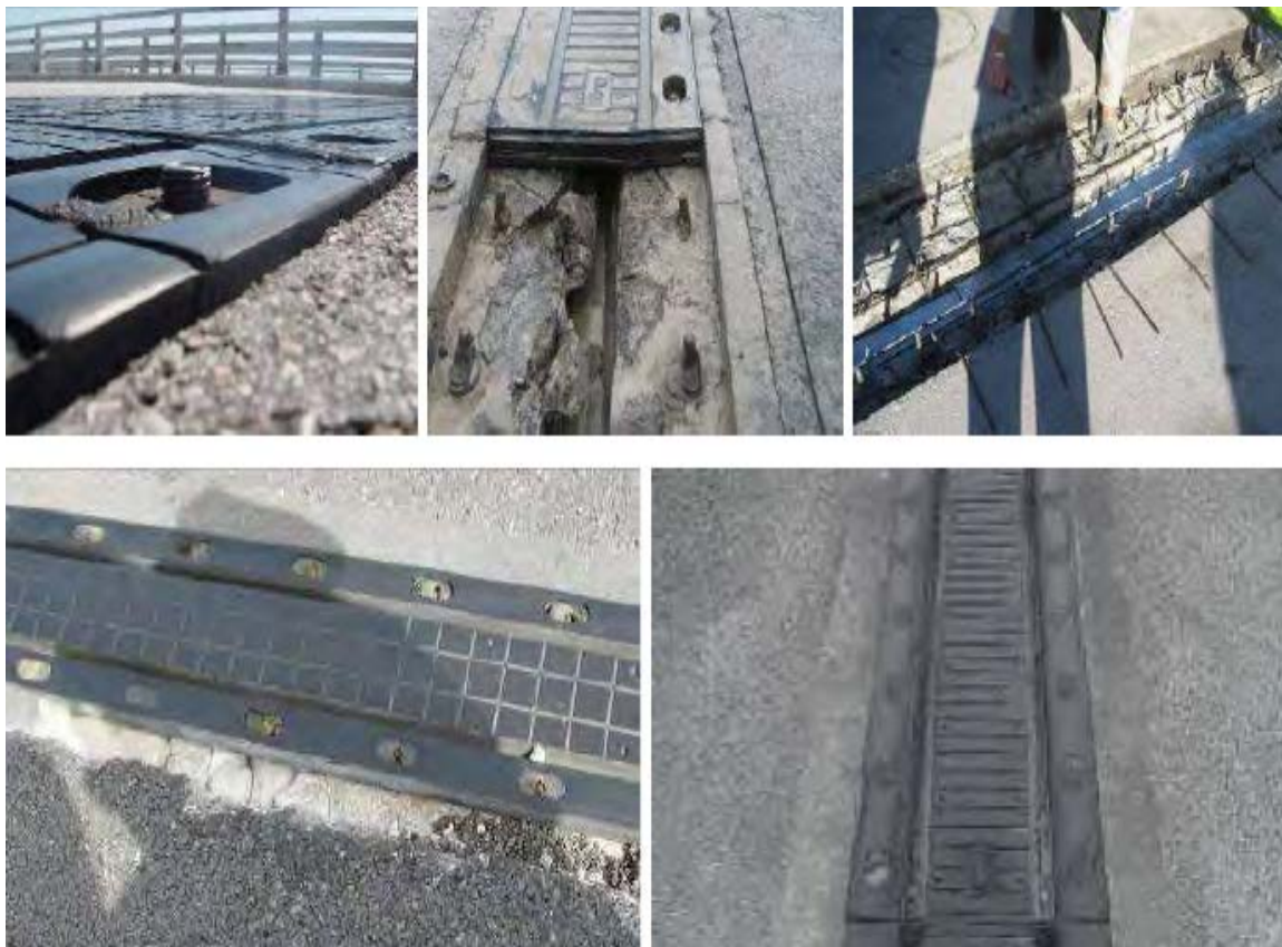
Εικόνα 3.4 Βλάβες και επισκευές ελαστομεταλλικών αρμών [14].
