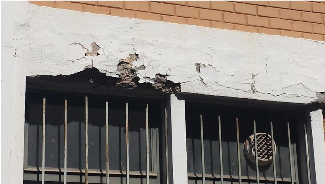
Εικόνα 5 Η ΑΠΟΚΑΤΑΣΤΑΣΗ ΤΩΝ ΖΗΜΙΩΝ ΜΕ ΑΝΘΡΑΚΟΝΙΜΑΤΑ ΑΠΑΙΤΕΙ ΤΗΝ ΔΙΕΞΟΔΙΚΗ ΜΕΛΕΤΗ ΤΗΣ ΑΝΤΟΧΗΣ ΤΟΥ ΦΕΡΟΝΤΟΣ ΟΡΓΑΝΙΣΜΟΥ ΜΕ ΤΗΝ ΜΕΘΟΔΟ ΕΞΑΓΩΓΗΣ ΠΥΡΗΝΩΝ ΑΠΟ ΤΙΣ ΔΟΚΟΥΣ ΚΑΙ ΤΑ ΥΠΟΣΤΥΛΩΜΑΤΑ.
