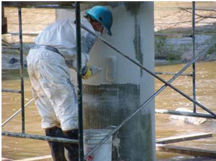
Εικόνα β: Στο ίδιο υποστήλωμα τοποθετείται γκρι χρωματισμός για να ταιριάζει με το σκυρόδεμα του υποστυλώματος.
