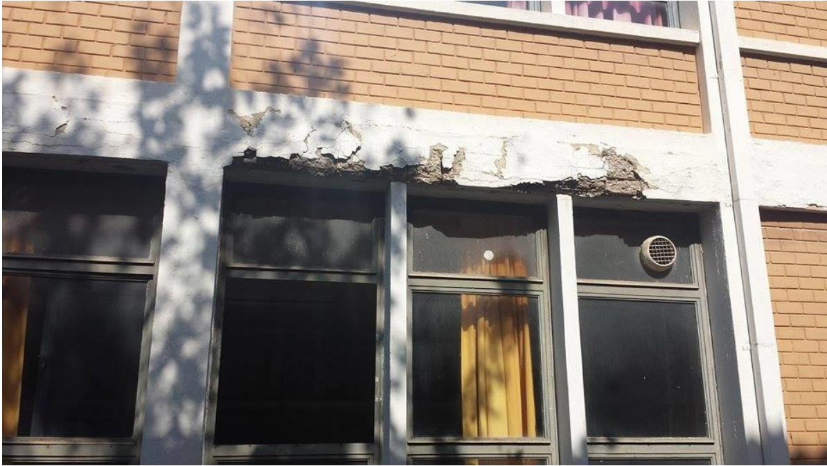
Εικόνα 1 ΑΠΟΚΛΙΣΗ ΣΚΥΡΟΔΕΜΑΤΟΣ ΑΠΟ ΟΡΙΖΟΝΤΙΟ ΕΞΩΤΕΡΙΚΟ ΔΟΚΑΡΙ ΤΟΥ ΚΤΙΡΙΟΥ.....
