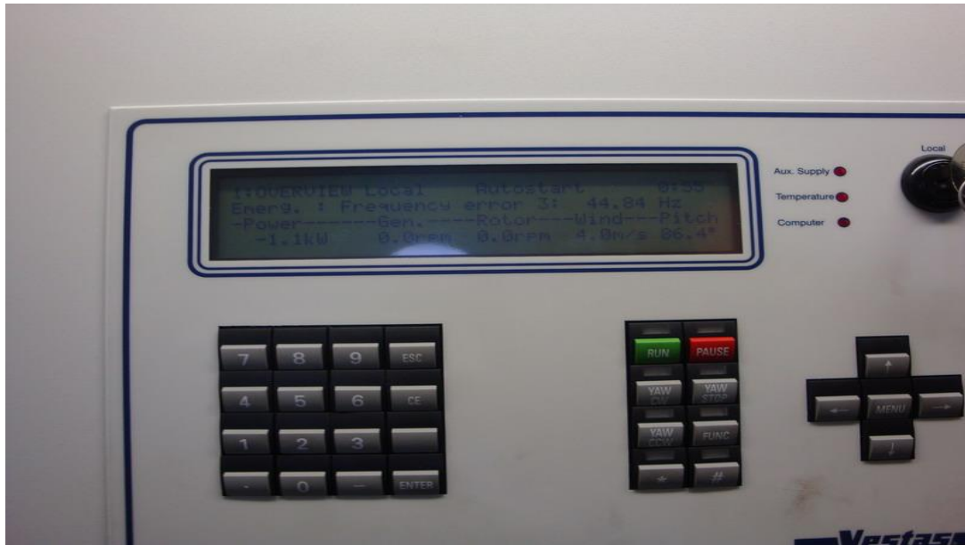
[Εικ. 37] Πίνακας ελέγχου CT291
