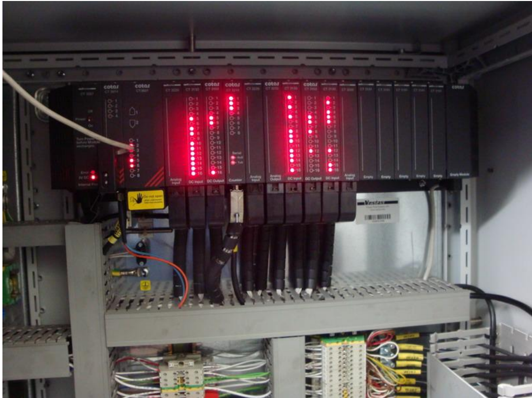
[Εικ. 39] Top Controller (ηλεκτικής)
