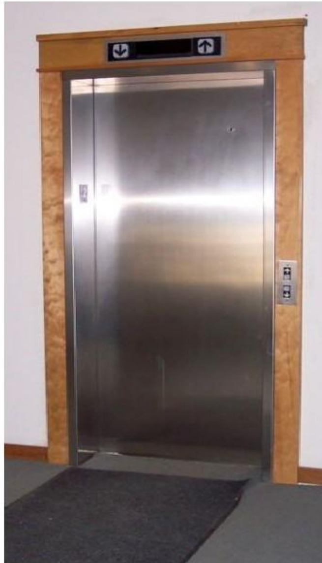
Αυτόματη πόρτα ανελκυστήρα
