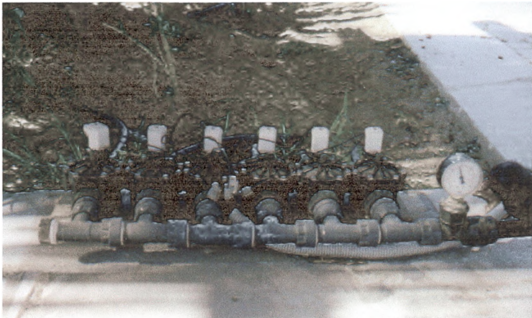
Εικ. 7 Ηλεκτροβάνες 1 ίντσας τοποθετημένες σε παροχές
