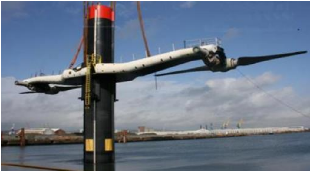
Εικόνα 3.2: Η γεννήτρια Seagen κατά την εγκατάστασή της.
